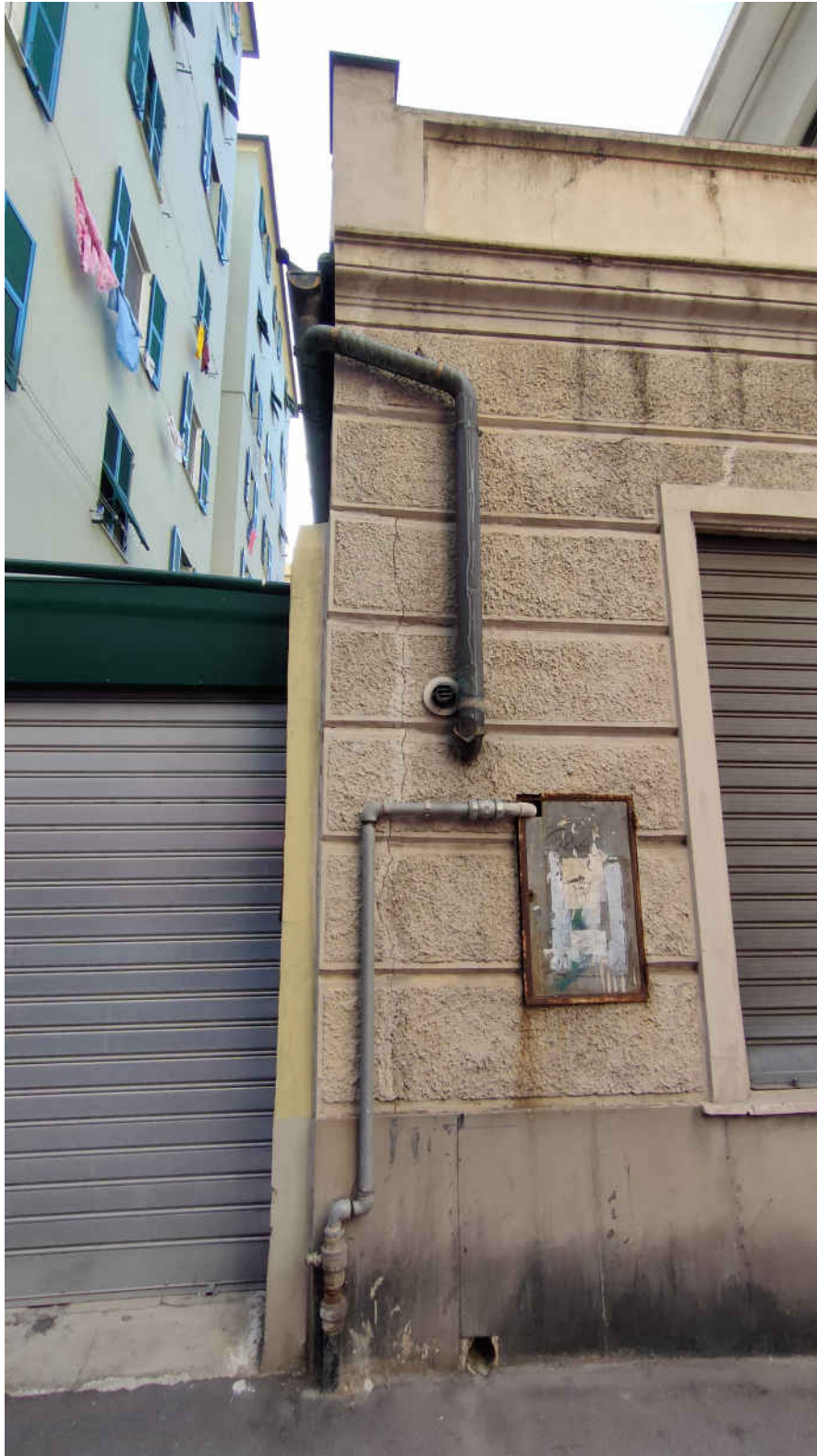
foto n. 8- Dettaglio facciata su via Malfettani con contatore del Gas. E' visibile una cavillatura verticale dello strato di intonaco.
