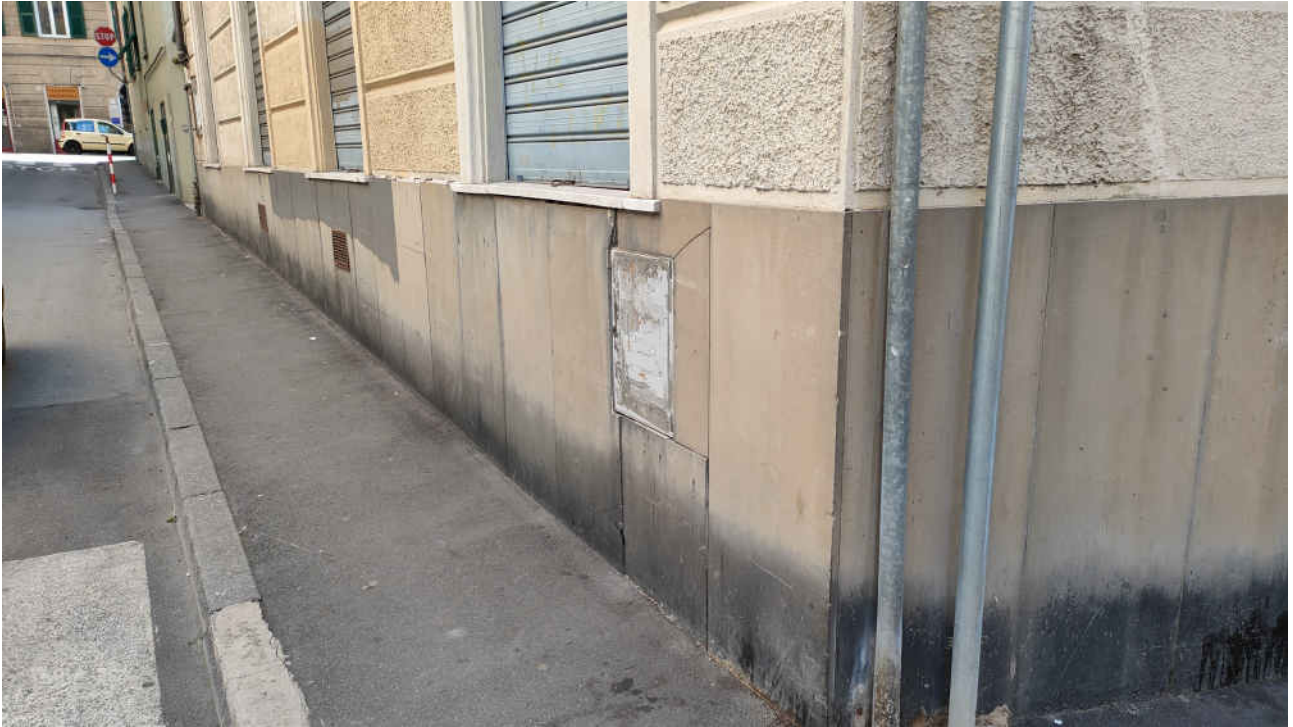
foto n. 9- Dettaglio facciata angolo via Malfettani e via Dattilo. Visibili le diverse tinteggiature della facciata, rotture dello zoccolo.
