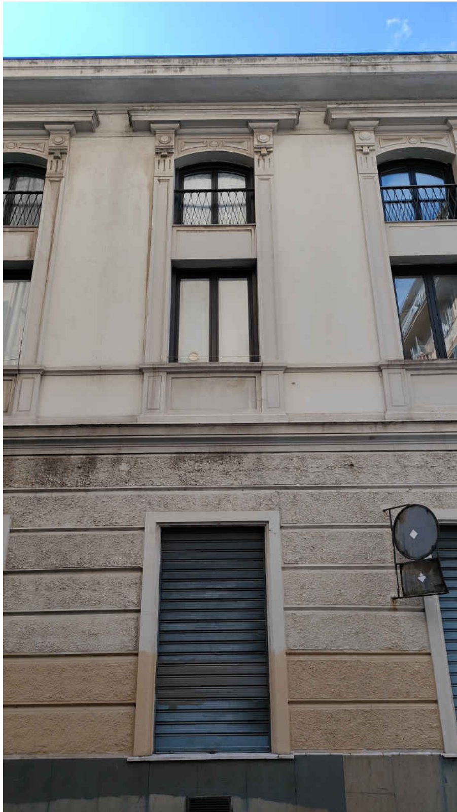
foto n. 10- Dettaglio facciata via Malfettani . Visibili le diverse tinteggiature della facciata.
