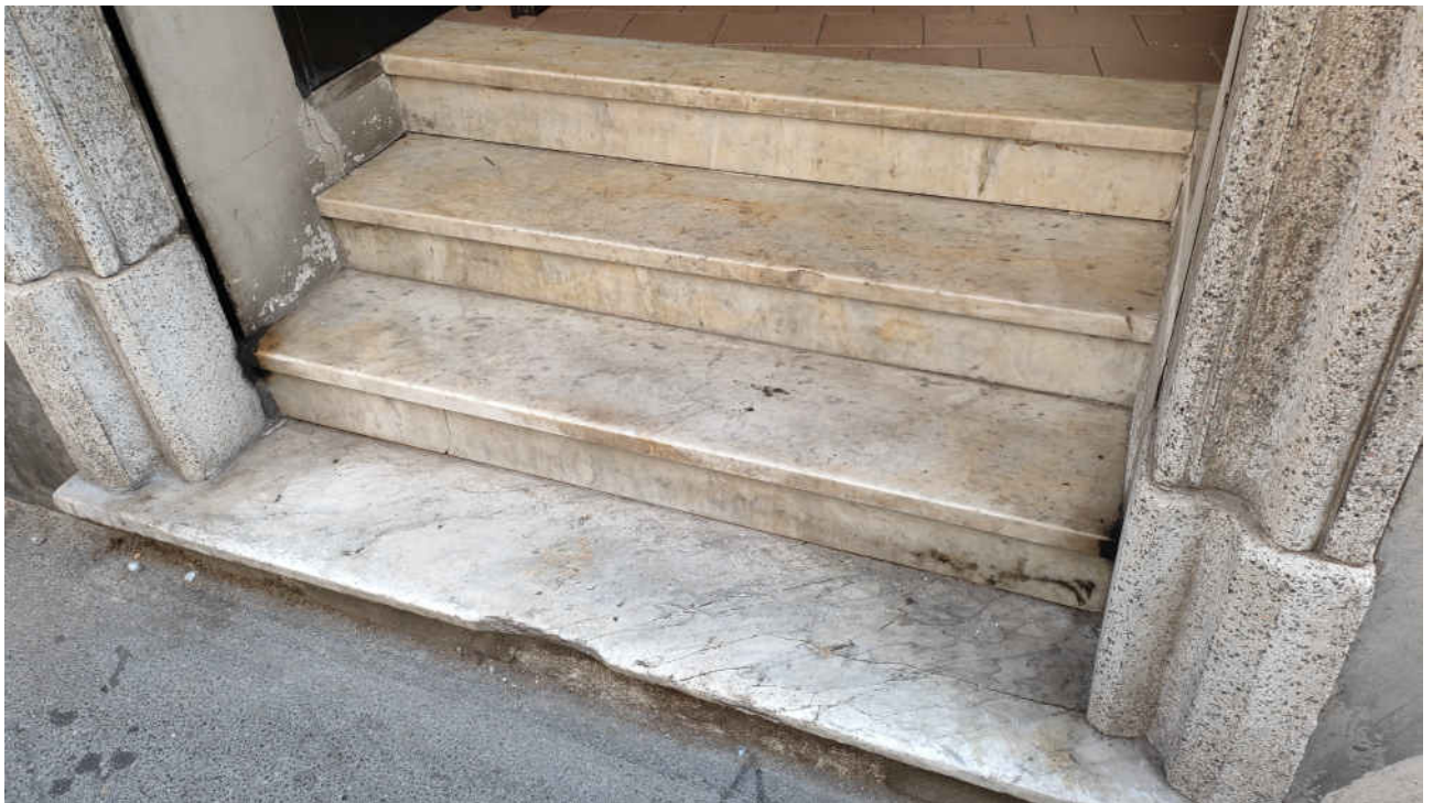
foto n. 7- Dettaglio pedate sbeccate scalini di accesso.
