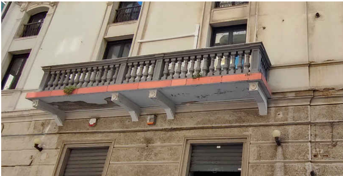
foto n. 12- Dettaglio poggiolo su via Dattilo. Visibili i distacchi di intonaco del celino e la fascia che ricopre il frontalino.
