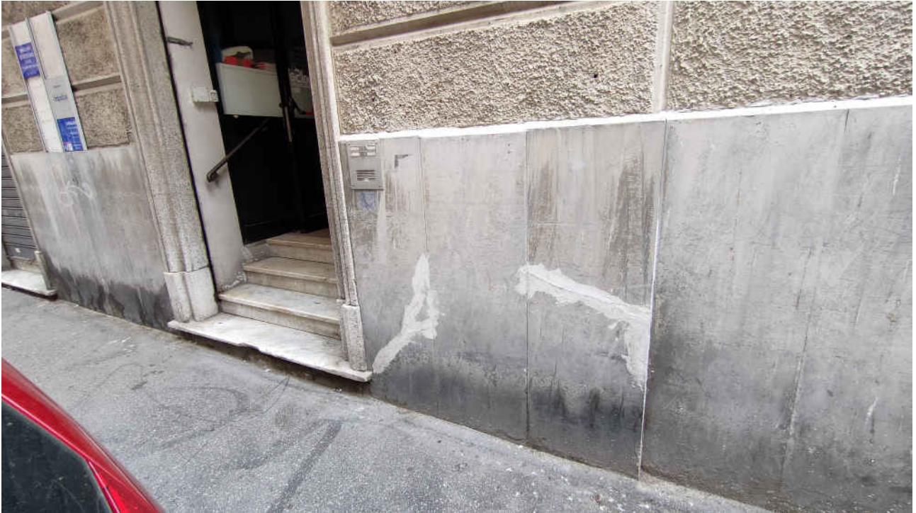
foto n. 6- Dettaglio zoccolo facciata su via Dattilo. Visibili le rotture delle lastre.
