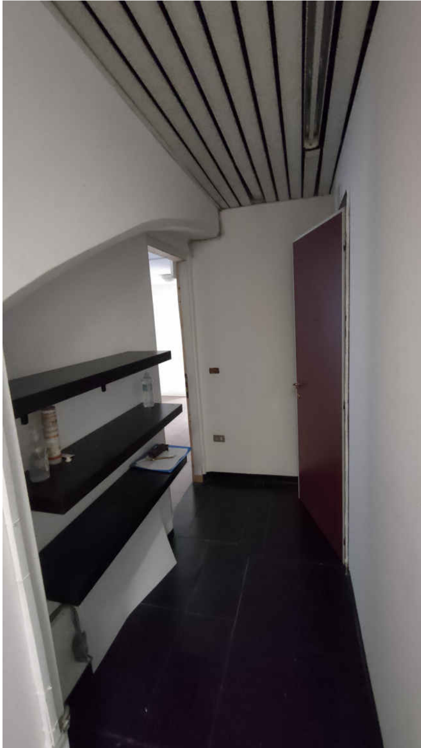
foto n.105- Locale 29 A- disimpegno con caldaia.
