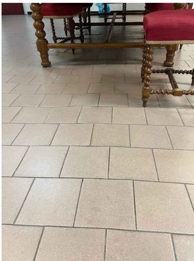
foto n. 25- Dettaglio pavimento piano terra , al centro dell'ingresso. Si notano le piastrelle sollevate al centro.
