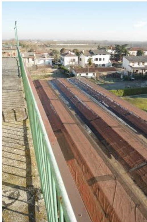
FOTO 10 - Vista della copertura del corpo capannone con manto in eternit rivestito da guaina impermeabile.
