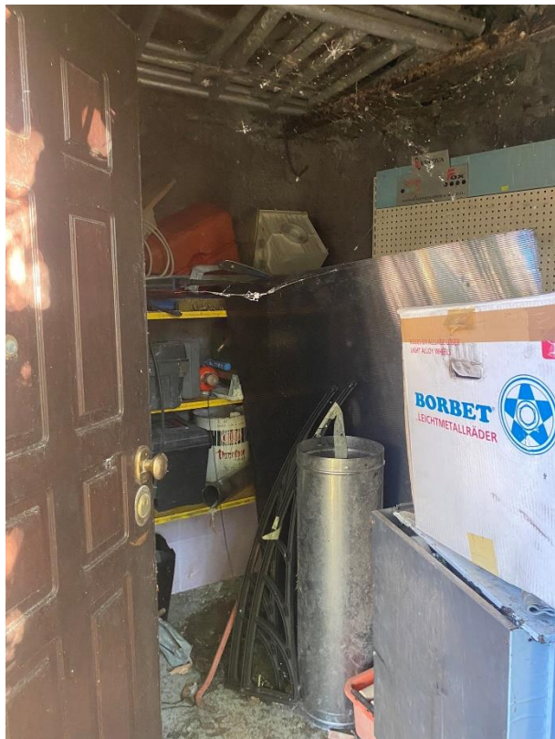
Foto 30 _ Vista interna_locale tecnico
