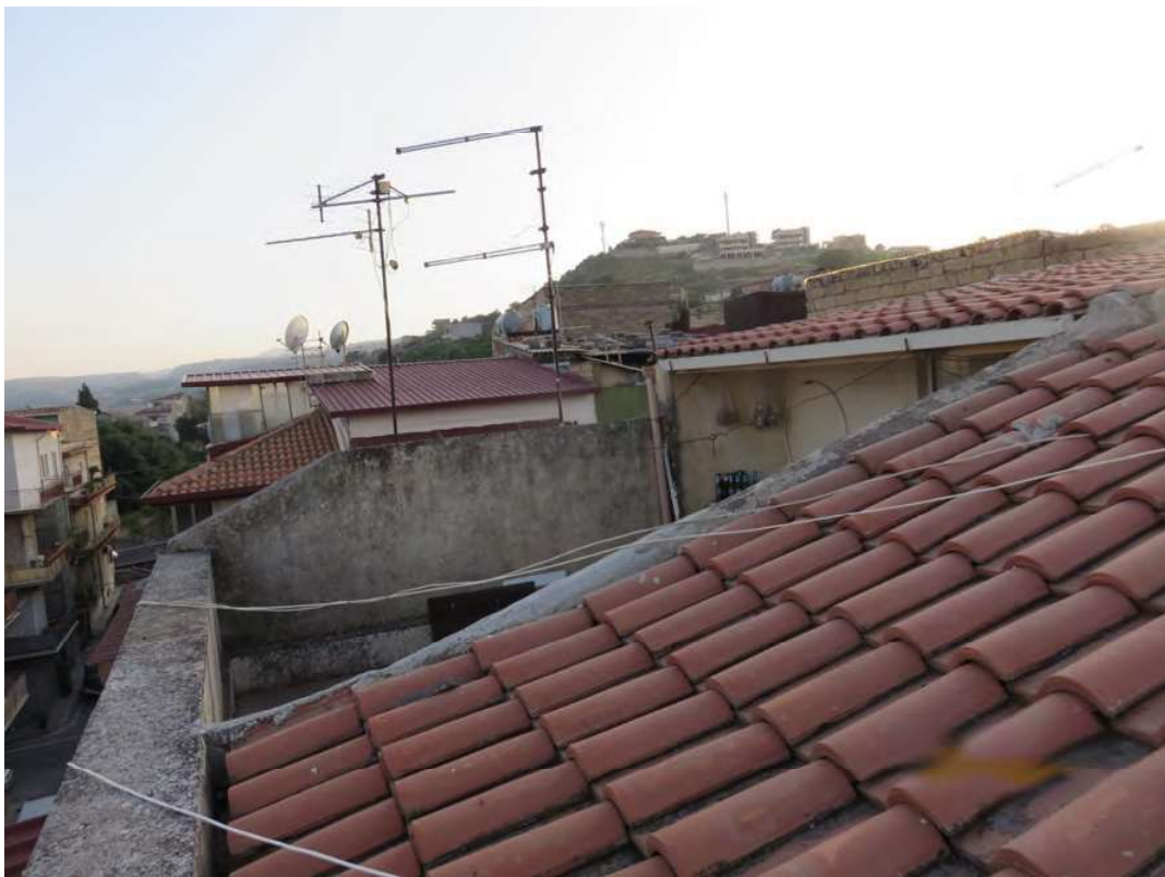
Illustrazione 6: Porzione di lastrico solare con volume non autorizzato e copertura scala
