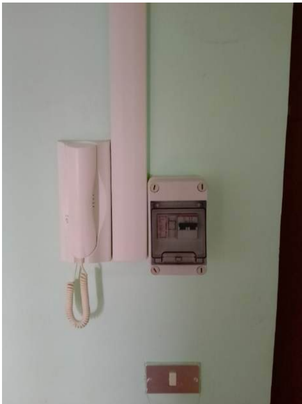
Foto 91, 92, 93 – Vista Interna – impianti
