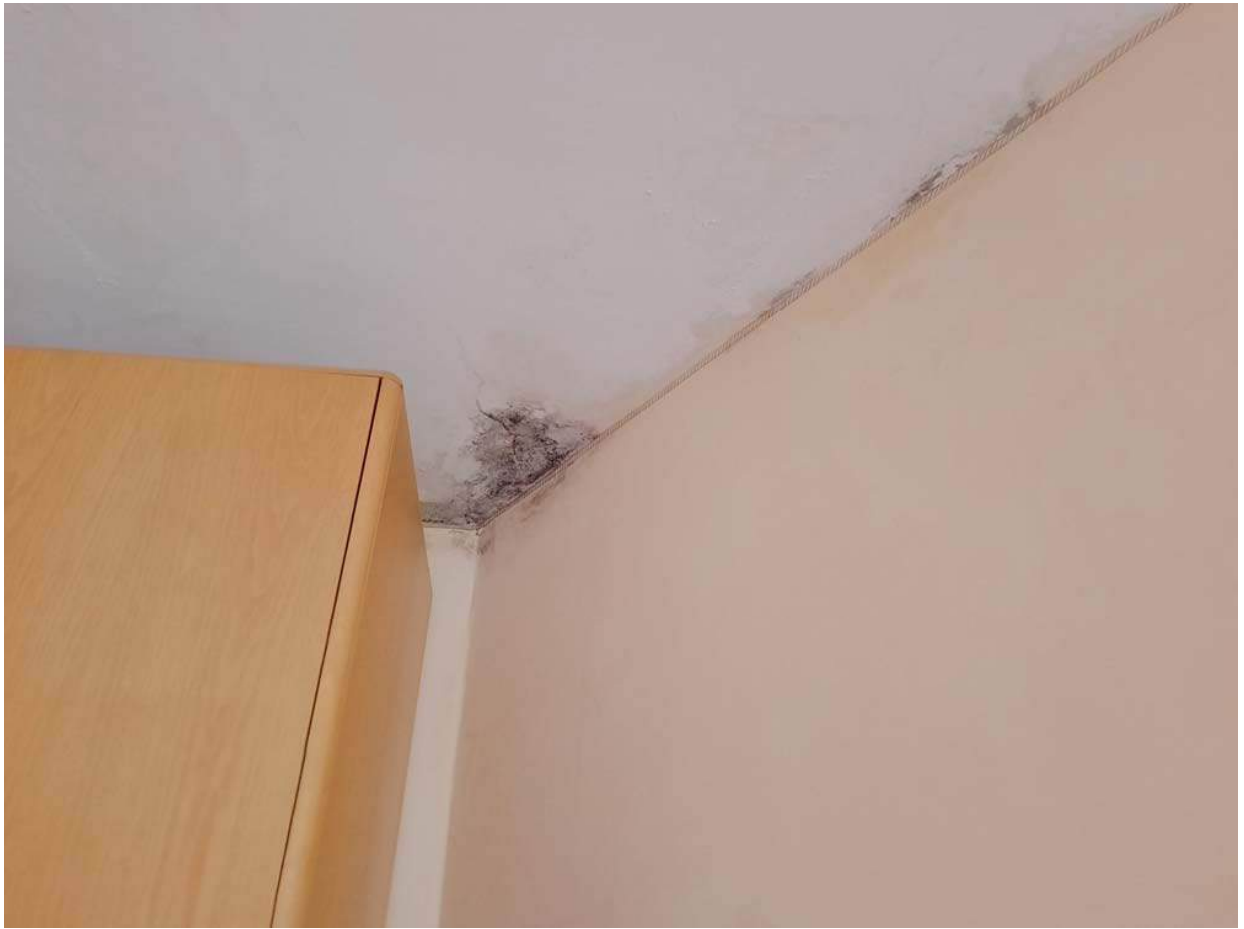
Foto 130 – Vista Interna – infiltrazioni
