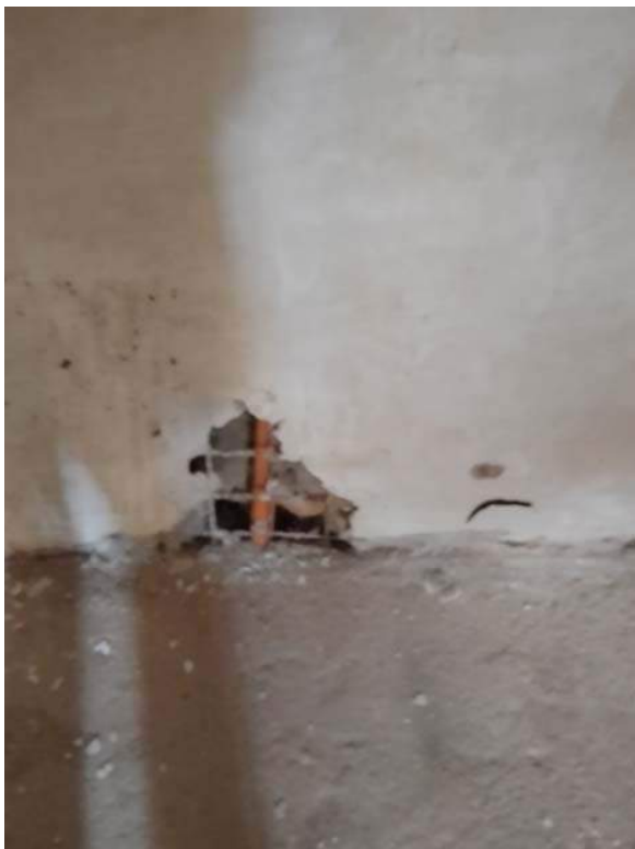
Foto 138, 139, 140 – Vista Interna – ammaloramenti
