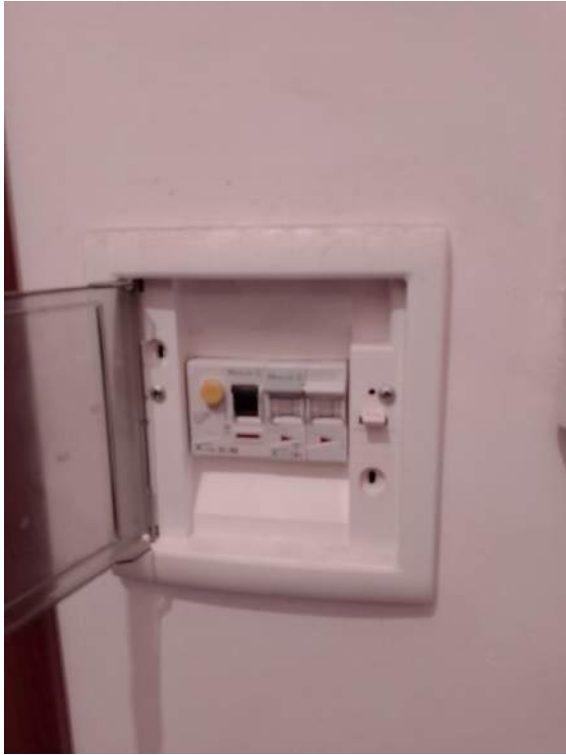
Foto 72, 73, 74 – Vista Interna – impianti
