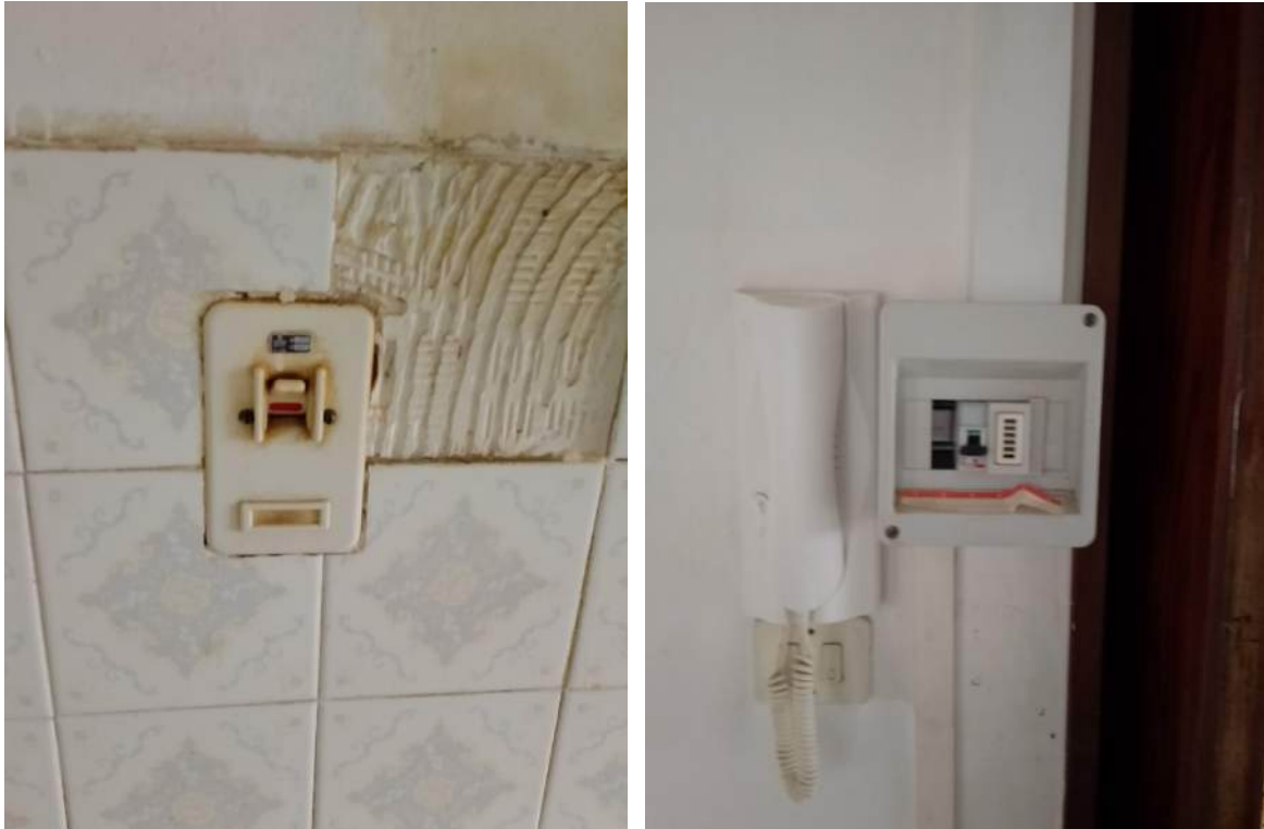
Foto 51, 52 – Vista Interna – impianti
