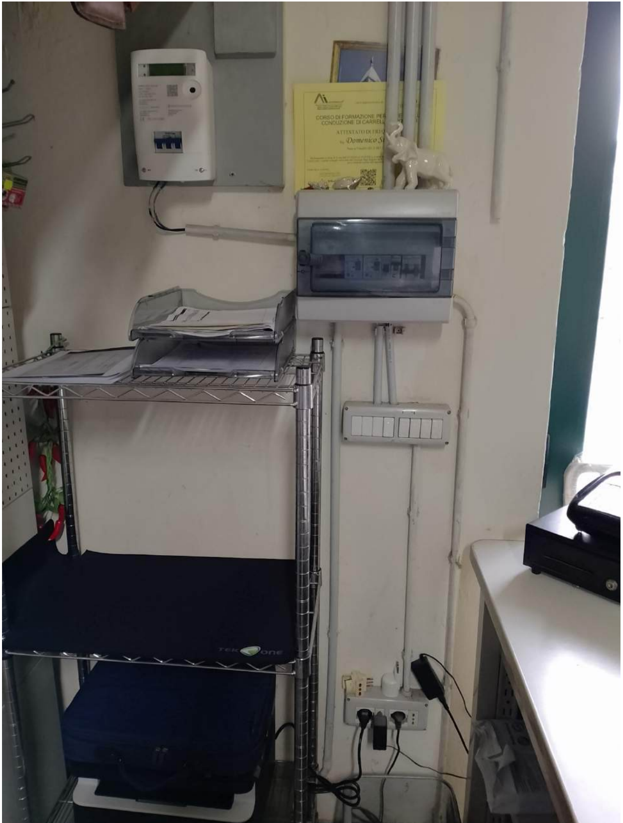
Foto 17 - Vista interna – centralino impianto elettrico
