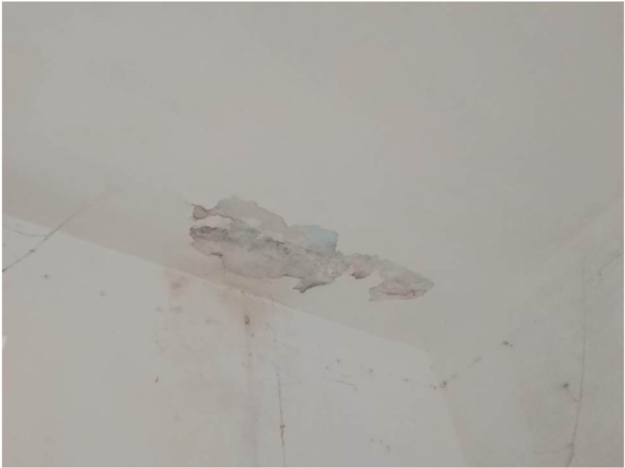
Foto 35 – Vista interna - infiltrazioni
