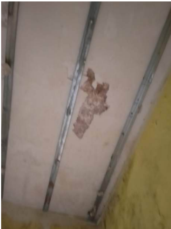
Foto 95, 96, 97 – Vista Interna – infiltrazioni
