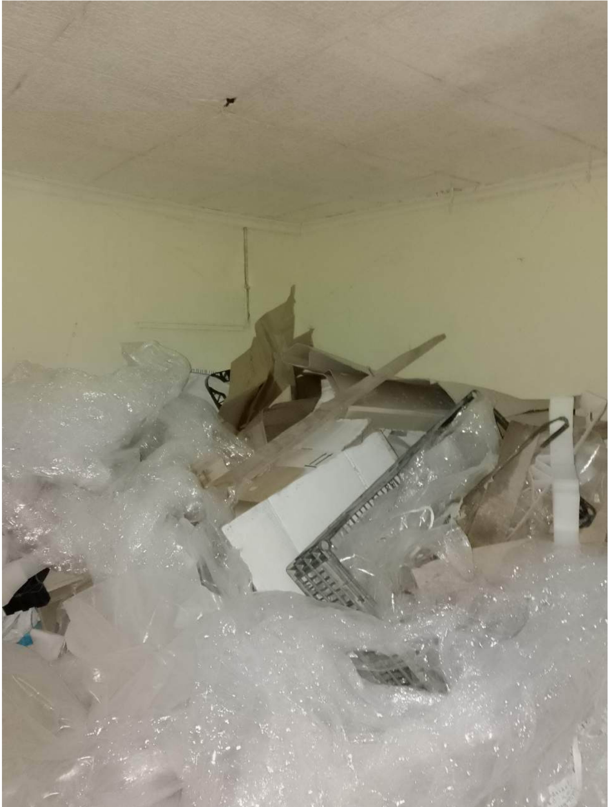
Foto 34 – Vista interna - infiltrazioni
