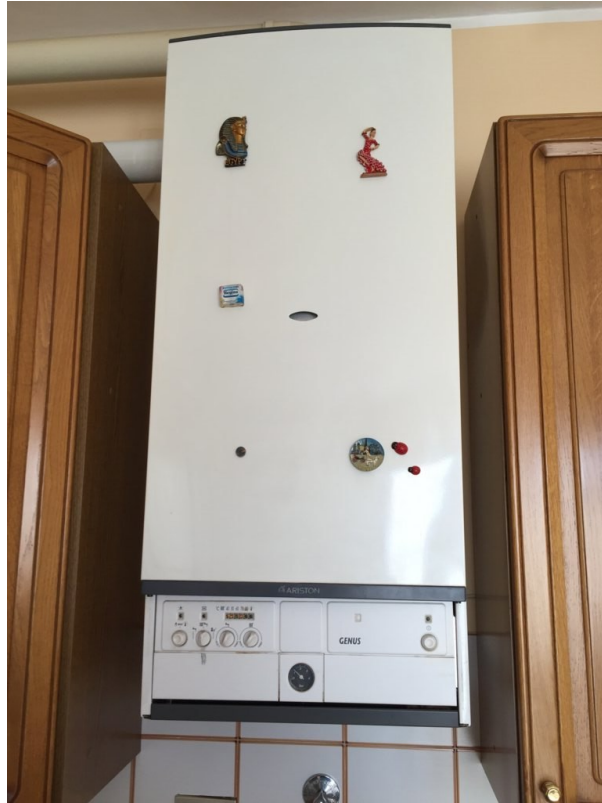
Foto 05 – Caldaia Piano Primo
