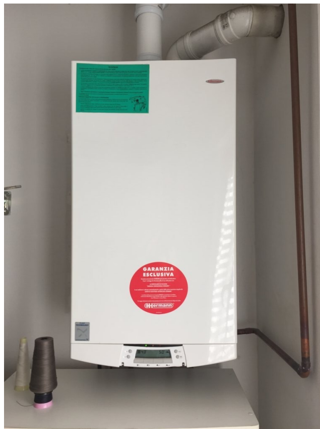
Foto 10 – Caldaia Piano Terra
