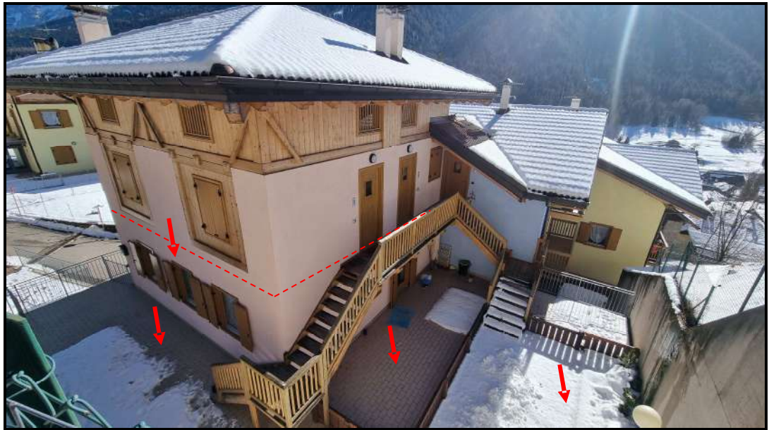
VISTA PROSPETTI NORD – OVEST E ANDITI P.ED. 513 (LOTTO 2) N.B. la scala è a servizio di altra unità abitativa non oggetto di pignoramento Vedasi planimetria piano divisione materiale
