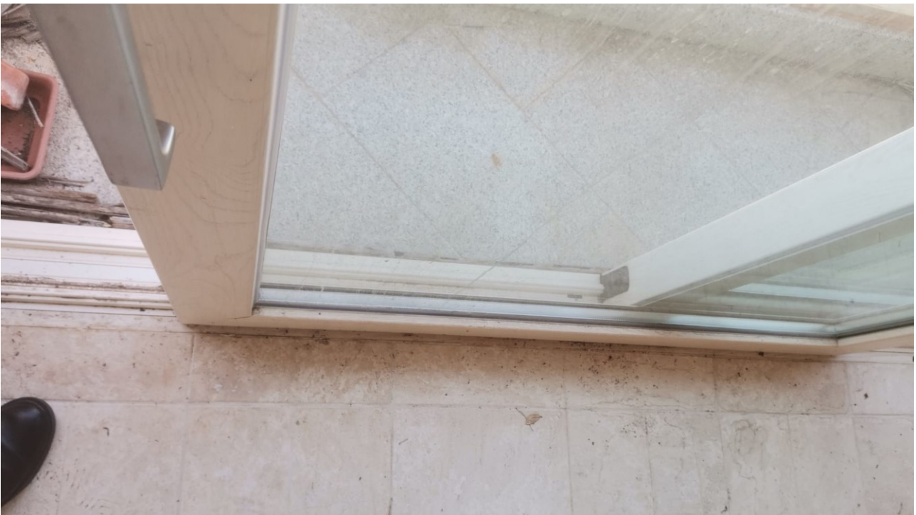
FIGURE 11: PARTICOLARE INFISSO VERANDA ZONA GIORNO DA RICOLLOCARE
