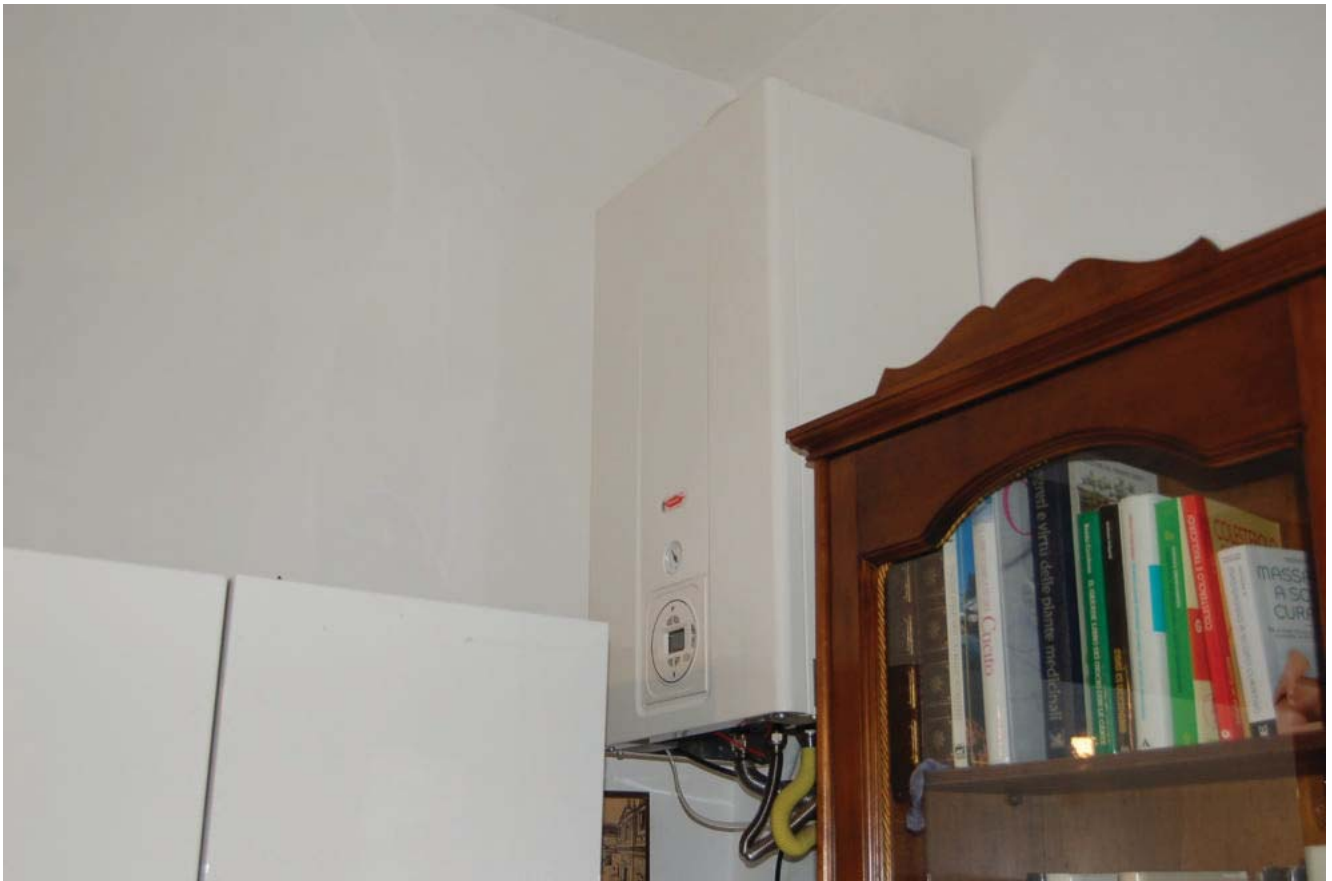
Foto 37- Dettaglio del generatore a gas
