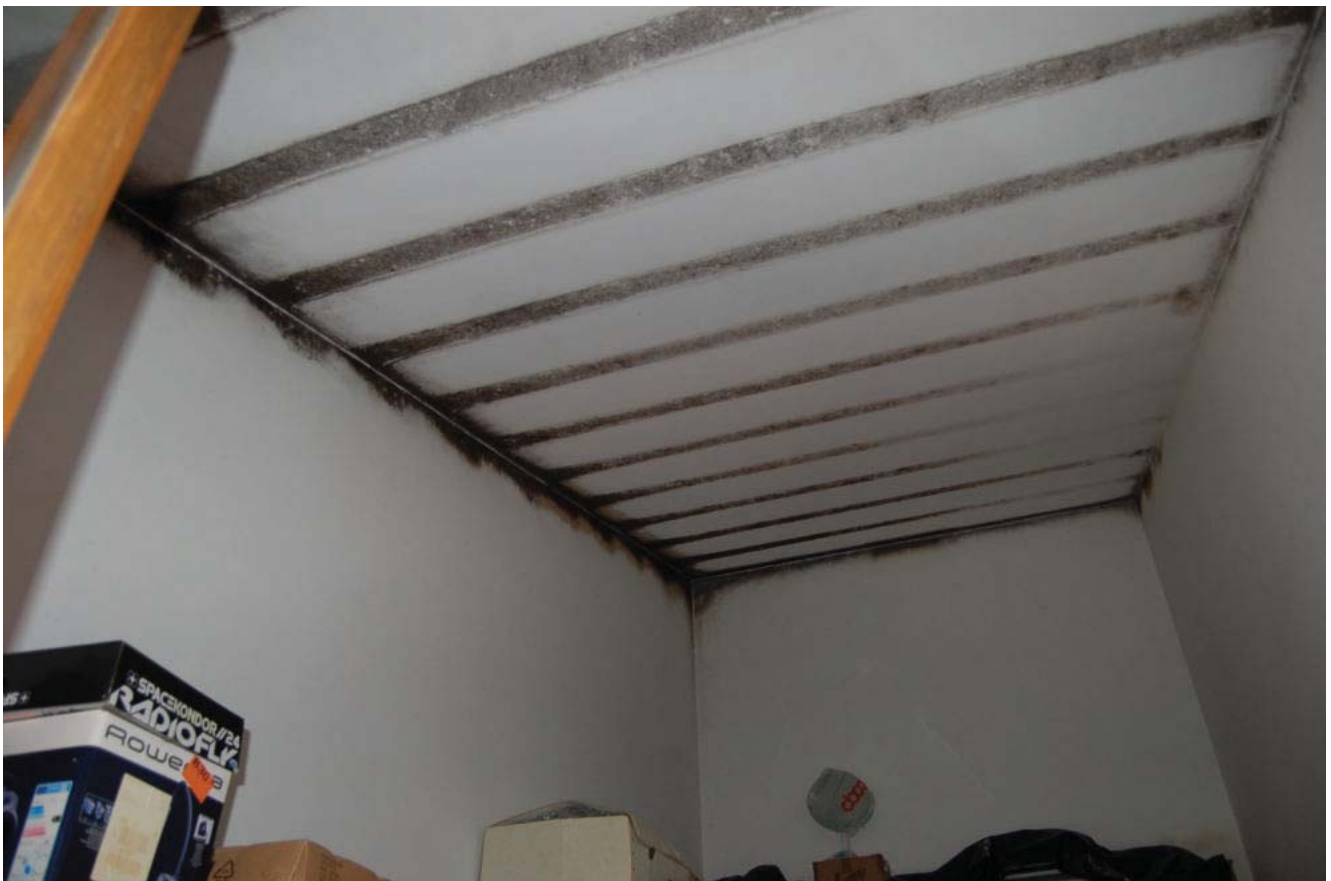
Foto 34 - Dettaglio dei fenomeni di degrado del locale adibito a ripostiglio
