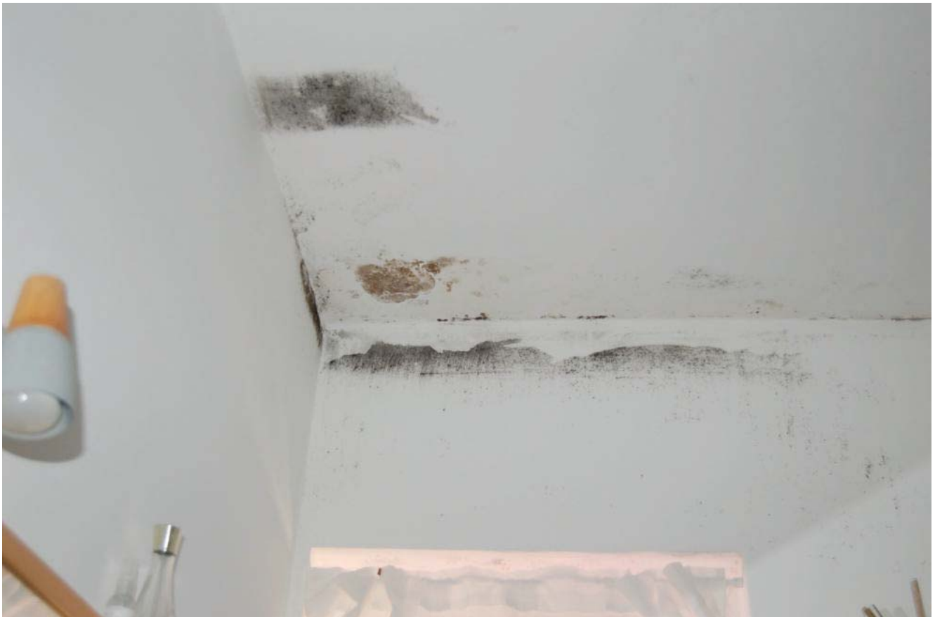
Foto 31 - Dettaglio dei fenomeni di degrado nel bagno della zona notte
