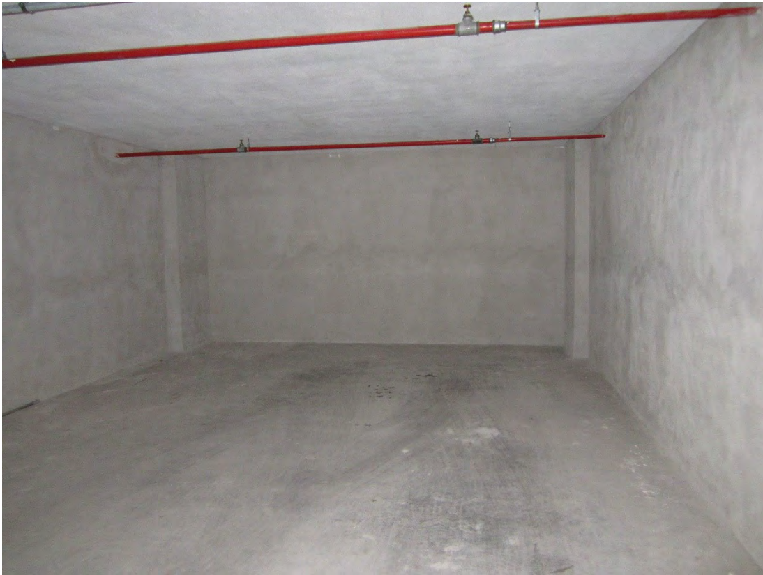
Foto 30: panoramica interna del locale box identificato, nel foglio 30, dalla particella 2515 sub. 164; nella parte alta della foto sono inquadrate le tubazioni antincendio che servono anche il locale
