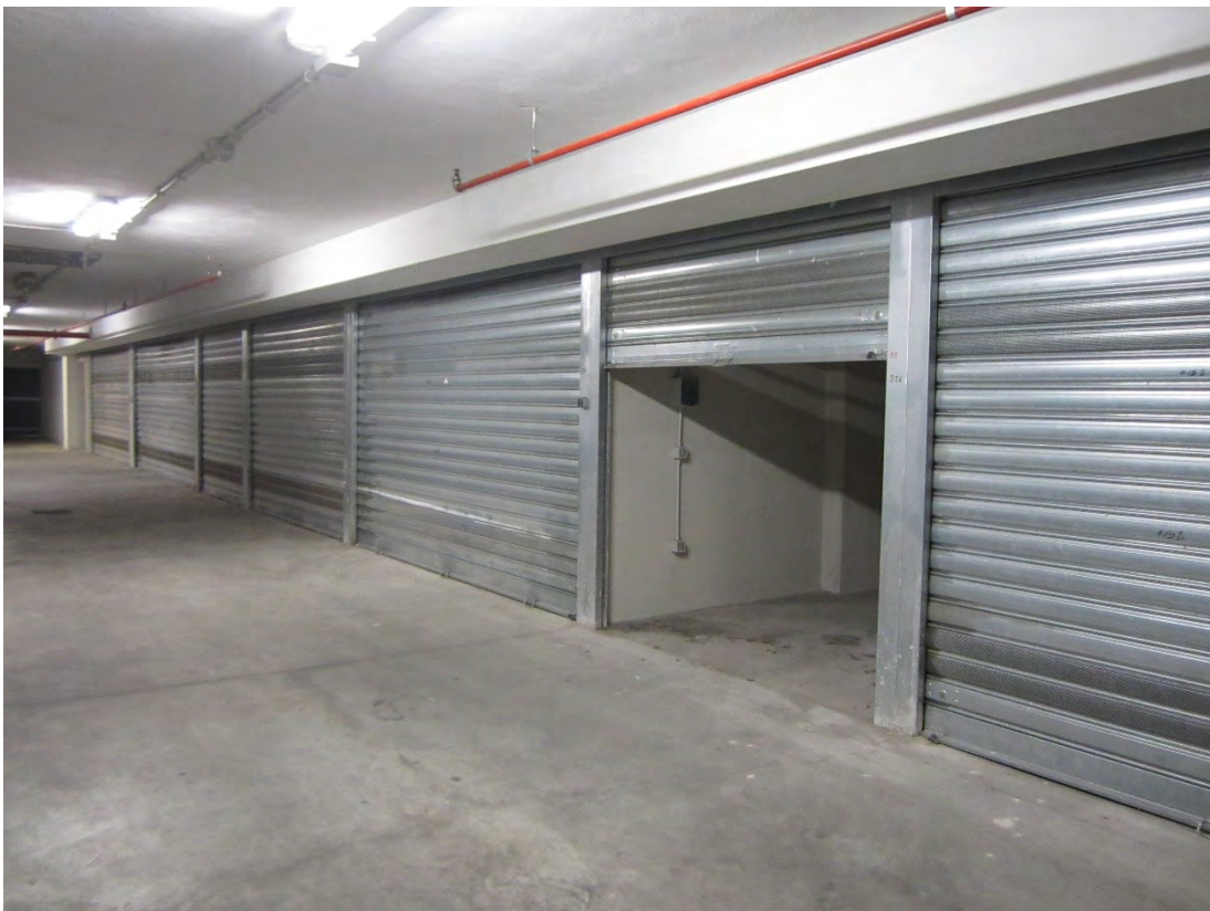
Foto 38: l'ingresso al locale sgombero/box identificato, nel foglio 30, dalla particella 2515 sub. 224, attraverso una serranda avvolgibile metallica
