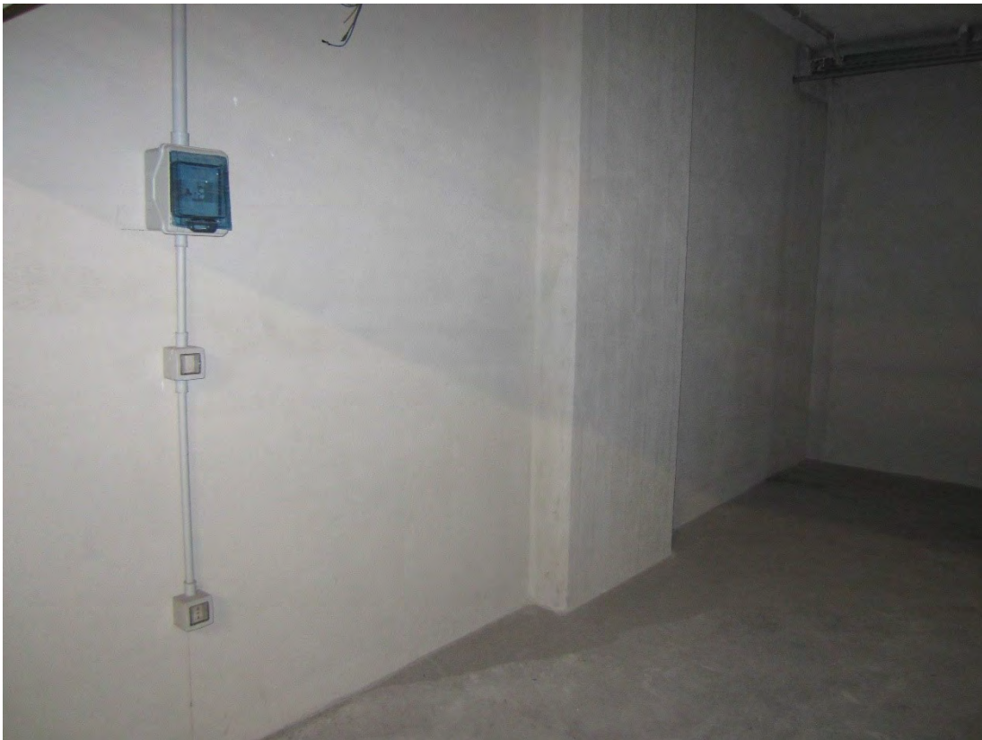
Foto 40: l'impianto elettrico a servizio del locale sgombero/box identificato, nel foglio 30, dalla particella 2515 sub. 224
