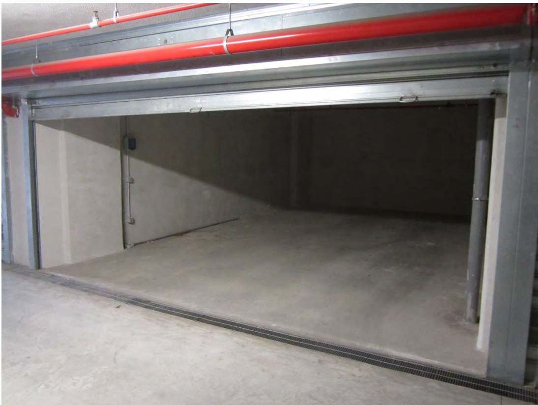
Foto 74: l'ingresso al locale box identificato, nel foglio 30, dalla particella 2515 sub. 322, attraverso una serranda avvolgibile metallica
