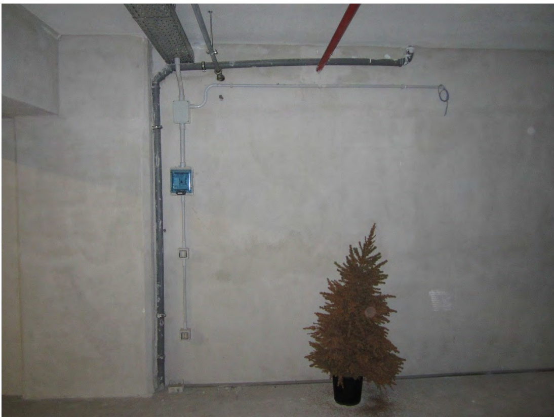
Foto 31: l'impianto elettrico a servizio del locale
