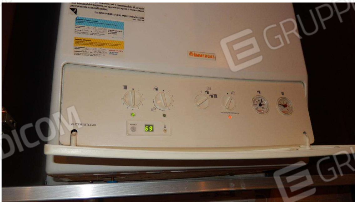
PARTICOLARE CALDAIA IN CUCINA
