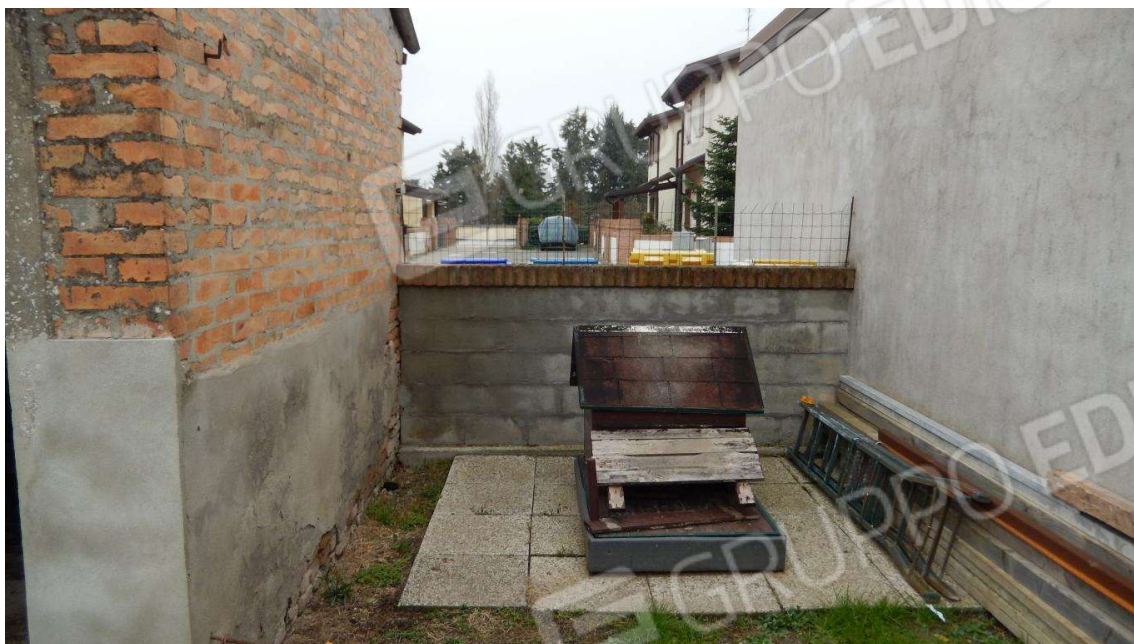
PARTICOLARE DOVE ERA PRESISTENTE APERTURA PASSO CARRABILE (EST), ORA MURATO E RIAPERTO SU LATO SUD
