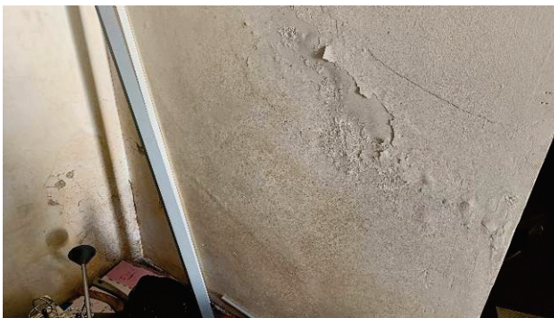
Ingresso - Umidità per perdita dai sanitari retrostanti (bidet, lavabo)
