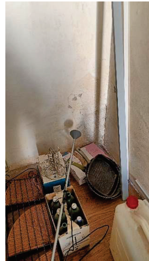
Ingresso - Umidità per perdita dai sanitari retrostanti (bidet, lavabo)
