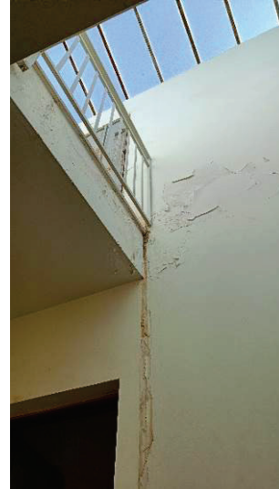
Umidità dal terrazzo superiore
