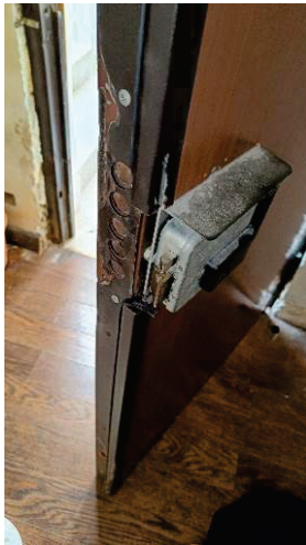
Ingresso - Porta blindata manomessa)
