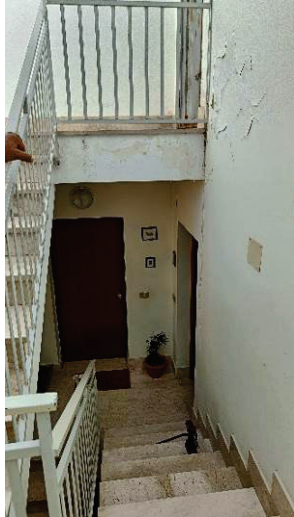
Umidità dal terrazzo superiore
