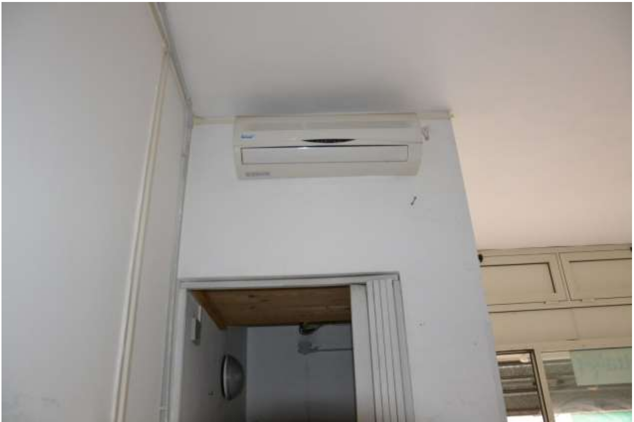
Vista interno – pompa di calore (manca unità esterna)
