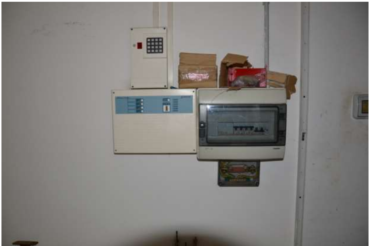
Particolare Quadro Elettrico e centralina allarme
