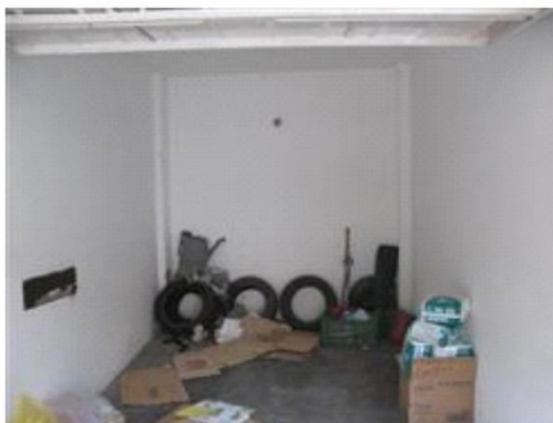
Vista interna box al sub. 4
