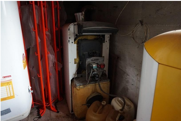
Piano seminterrato: c.t. con caldaia (dismessa)
