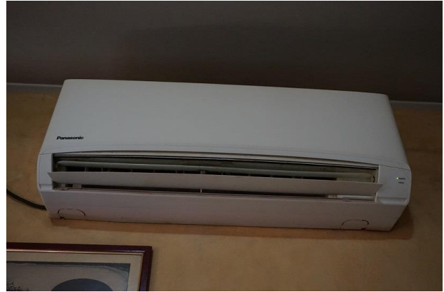
Piano rialzato: climatizzatore in soggiorno
