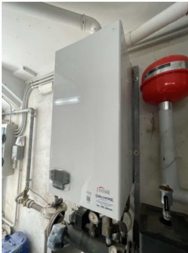
Foto n°26 : caldaia del gas metano condominiale
