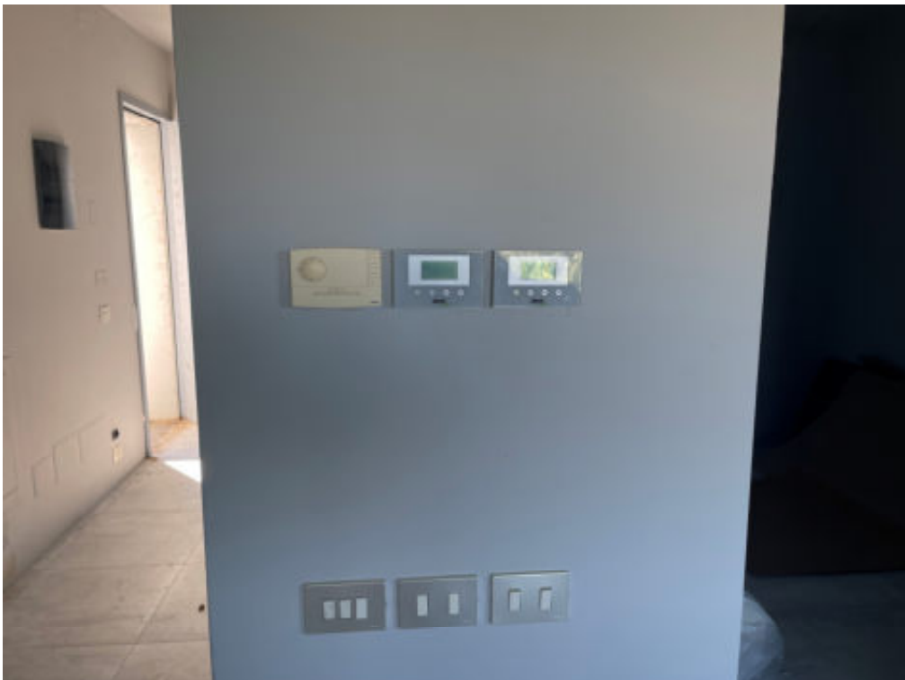
Foto n° 20: termostati per riscaldamento e raffreddamento
