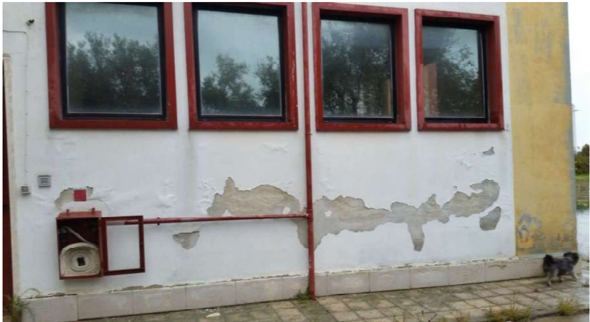
Foto 1-2-3: Degrado accentuato dei prospetti
