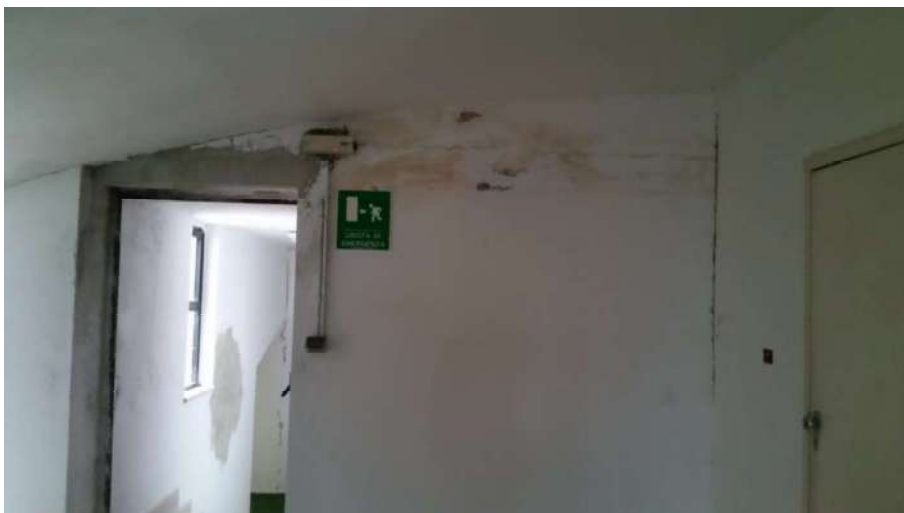
Foto 8-9: Infiltrazione acque meteoriche dalle coperture
