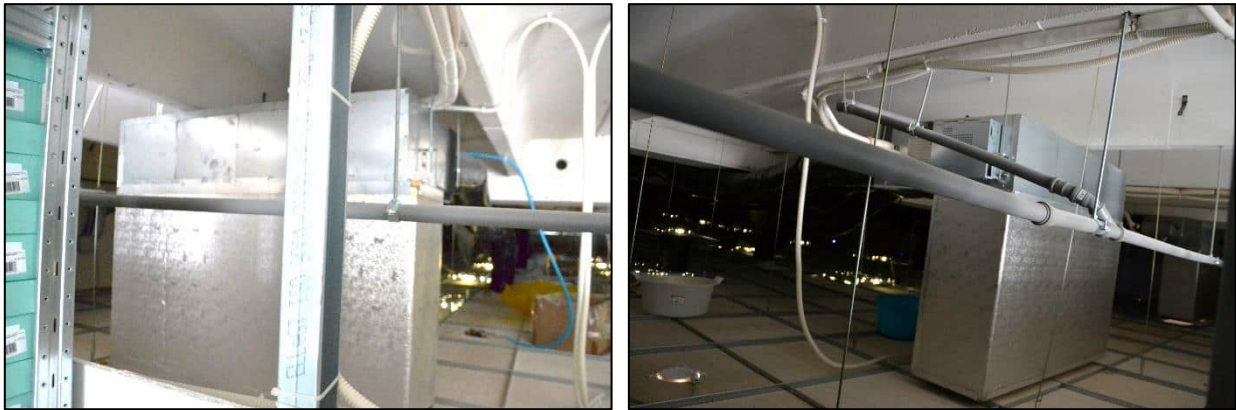
Figura 35 - Unità di trattamento aria
