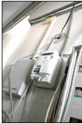
Figura 30 - Contatore energia elettrica – Subalterno 12
