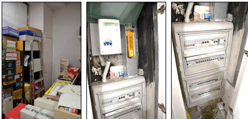
Figura 32 - Contatore energia elettrica – Subalterno 27
