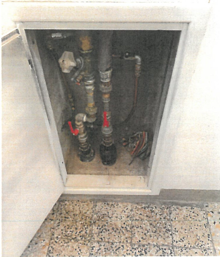
Foto n° 40 veduta allaccio teleriscaldamento nel vano scala al piano terra
