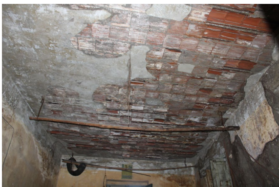
Figura 9 – Interno negozio – Succielo crollato
