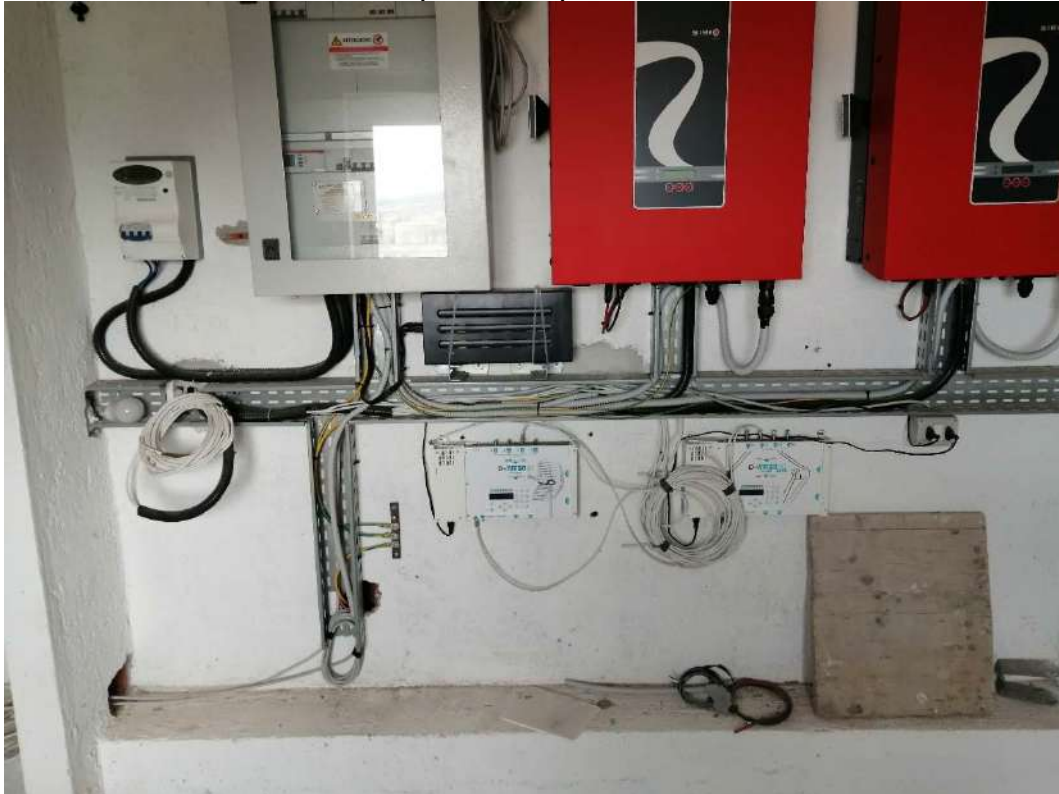
Foto n.62 particolare impianto fotovoltaico
