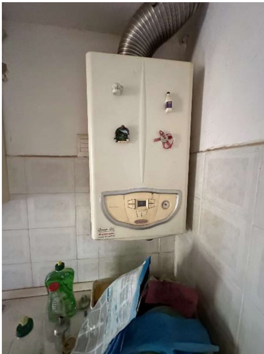
Foto 16 – generatore autonomo al PT
