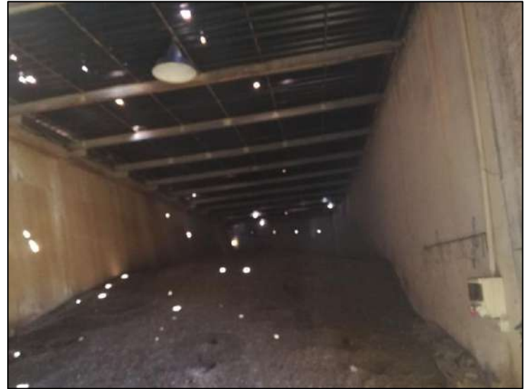
interno fabbricato abusivo
