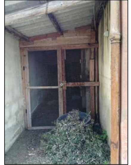
piccola tettoia abusiva
