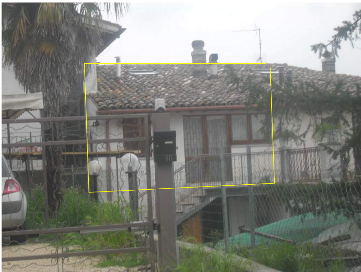
Foto n. 4 – Vista del prospetto frontale della porzione oggetto di esecuzione con particolare degli infissi e della copertura (accesso su scala davanti non consentito)
