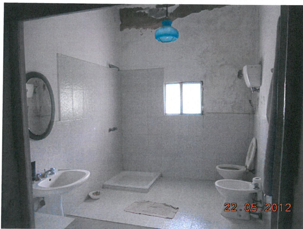
Foto n°14 – N.C.E.U. del Comune di Perugia, località Sant'Orfeto – Lotto "1"
