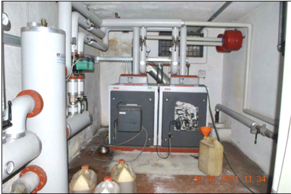
↑ La centrale termica a gasolio.
