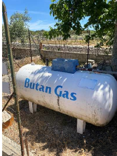
Serbatoio GPL (lato nord)
