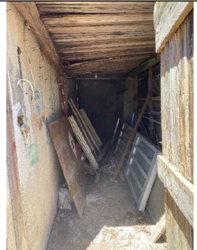
Locale con lastre esterne di copertura in amianto (lato nord)
