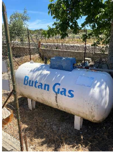
Serbatoio GPL (lato nord)
