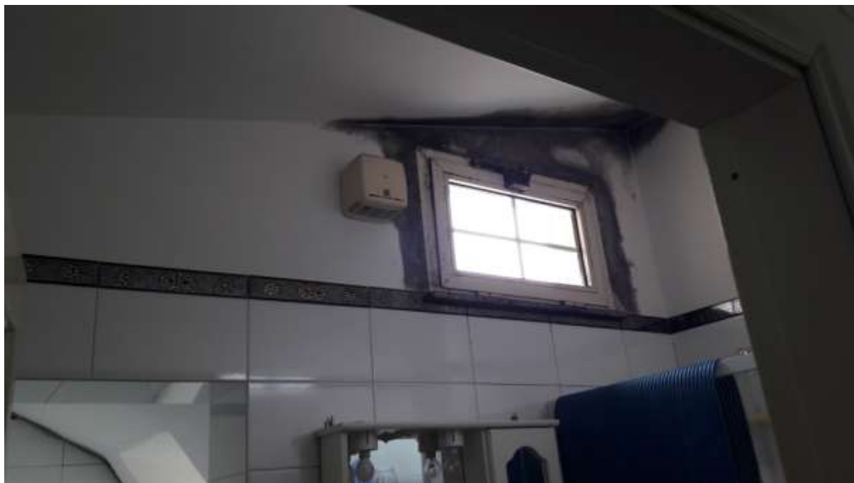
Foto 31 – Vista interna antibagno del secondo piano, con macchie di muffa attorno alla vasistas
