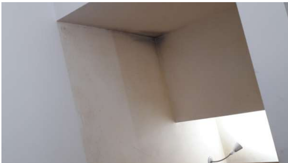
Foto 28 – Vista interna dal pianerottolo del secondo piano: macchie di muffa 1
