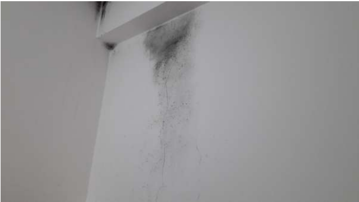
Foto 30 – Vista interna disimpegno del secondo piano: macchie di muffa 3
