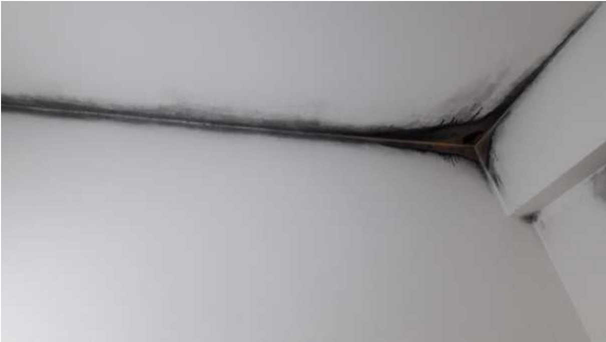
Foto 29 – Vista interna disimpegno del secondo piano: macchie di muffa 2
