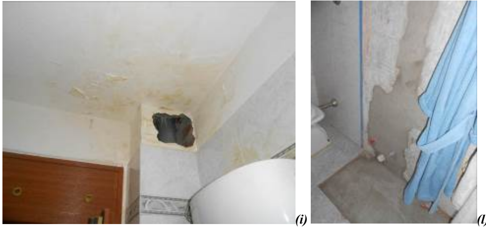
Figura n° 4. Fotografie dell'appartamento ubicato in via Fontane n° 22 – interni 3 e 4 - piano rialzato: soggiorno (a); cucina (b); bagni (c); balconi (d); camere (e); ingresso (f); corridoio (g); ripostiglio (h); infiltrazione nel bagno (i); porzioni di parete e di pavimento senza mattonelle (l).
