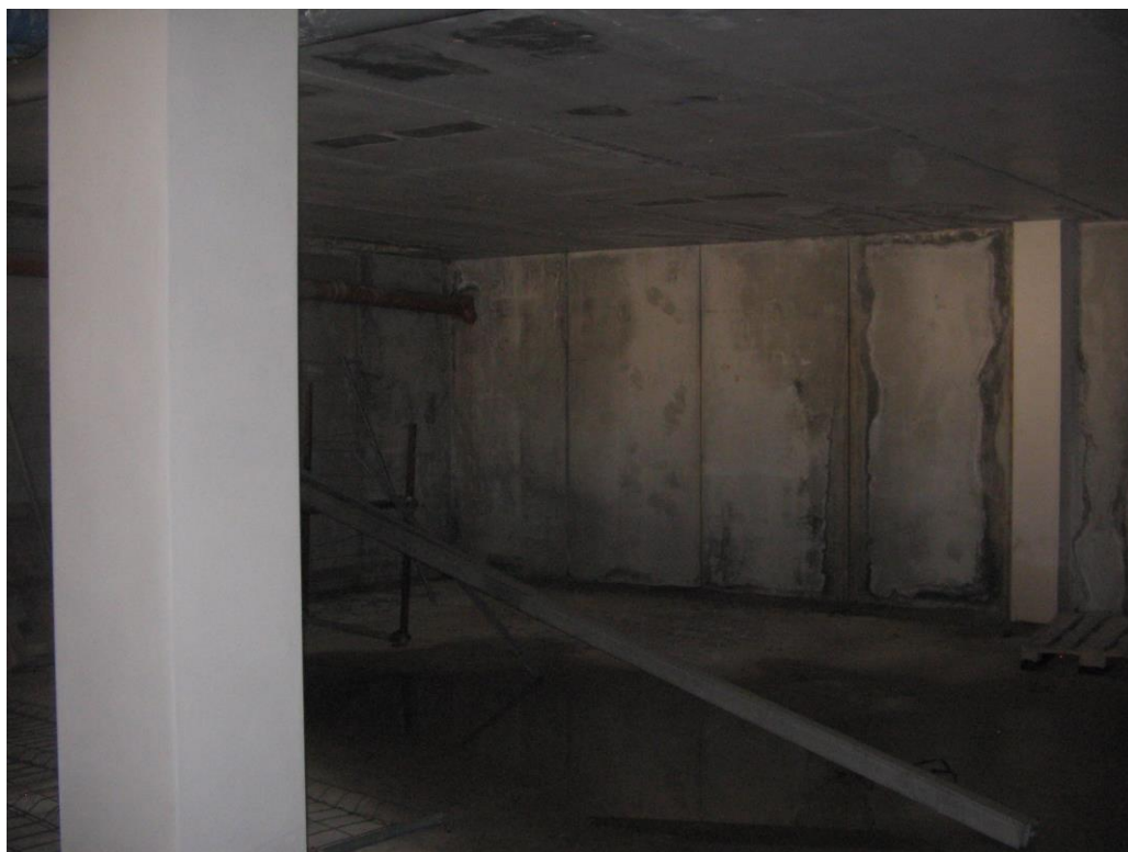
Sottolocale deposito – cattivo stato di manutenzione
