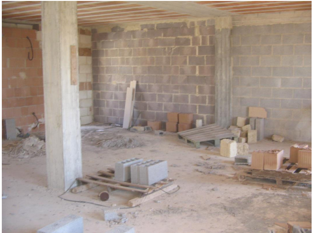
Abitazione priva di tramezzature – piano primo
