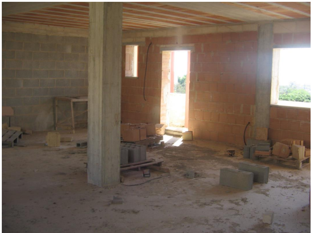
Abitazione priva di tramezzature – piano primo
