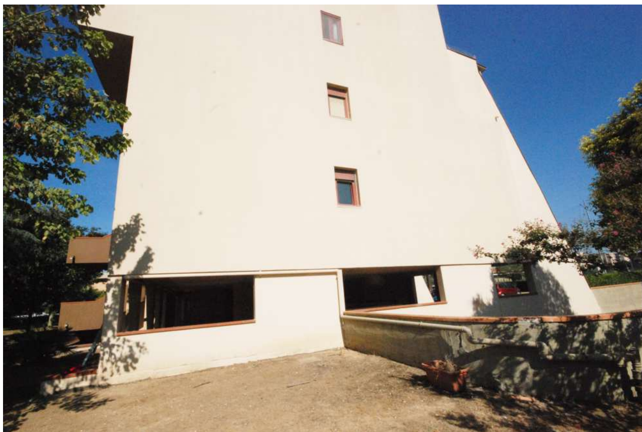
Il lato dell'edificio sul quale si aprono le finestre del corridoio (piano II) e del bagno (piano I)
