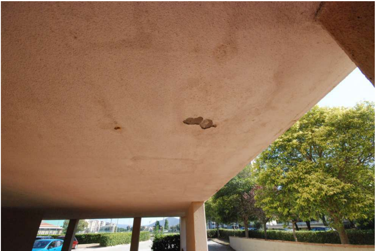
Le macchie, dovute alla perdita di acqua dal bagno, nel porticato del palazzo
