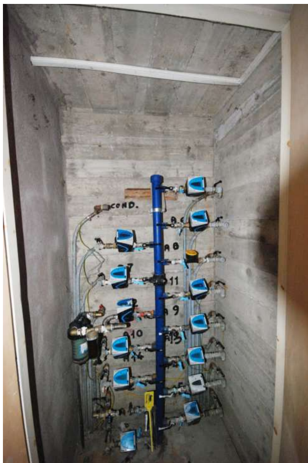
Contatori nel vano scala comune
