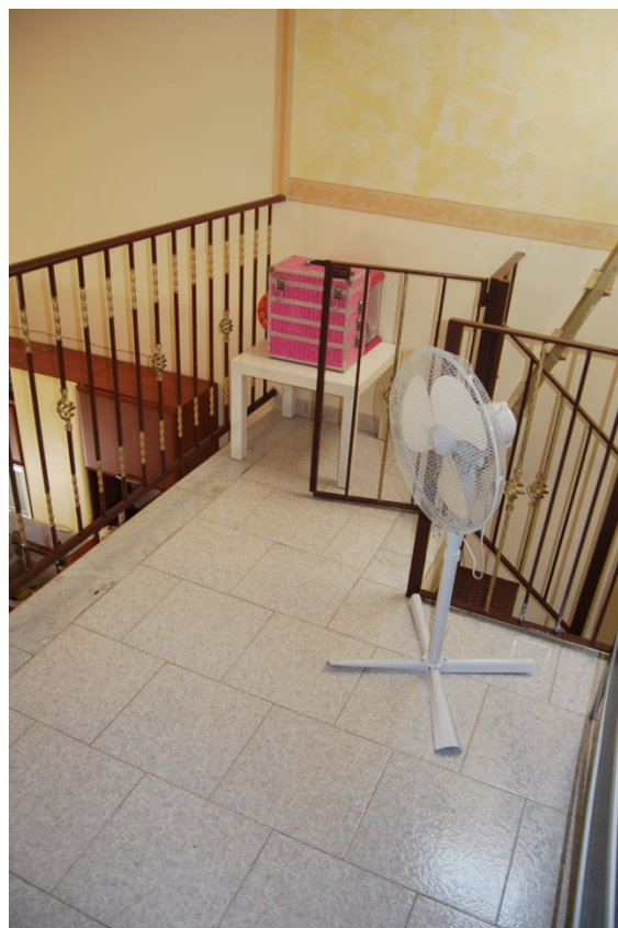
FOTO 8 PARTICOLARE SCALA SOPPALCO U. IMMOBILIARE PORZIONE 1
