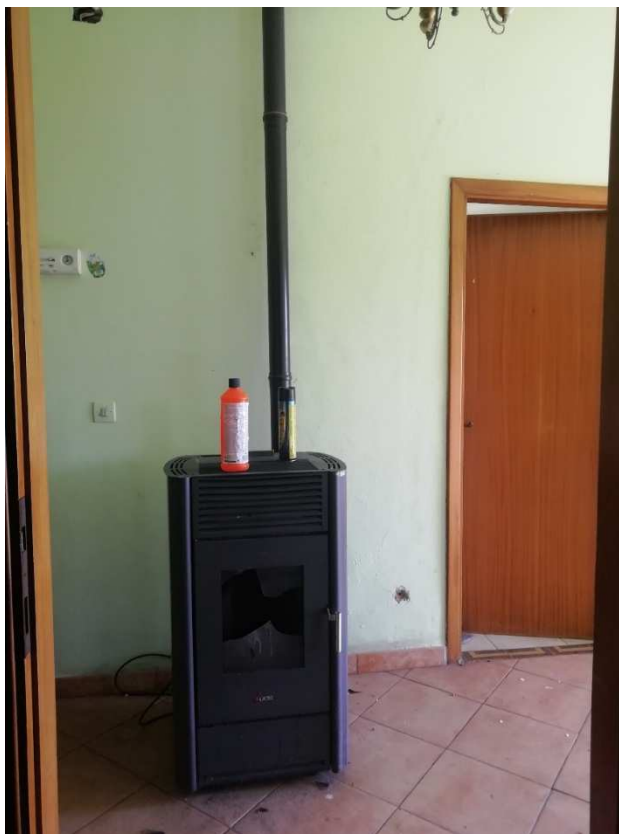
Foto 23 – Stufa a pellet – disimpegno
