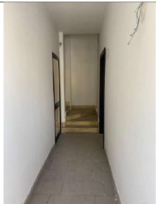
Foto 3: corridoio ingresso uffici. Sulla sinistra si accede allo stanzone al piano terra, mentre dalla porta sulla sinistra si entra in una stanza ricavata nel precedente androne di accesso. Tale stanza assieme ad una finestra sul prospetto non sono presenti nella piantina catastale. In fondo la scala per gli uffici del primo piano
