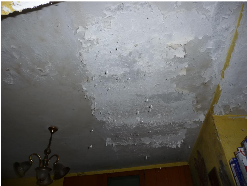
Foto 13 – Infiltrazioni soffitto piano primo
