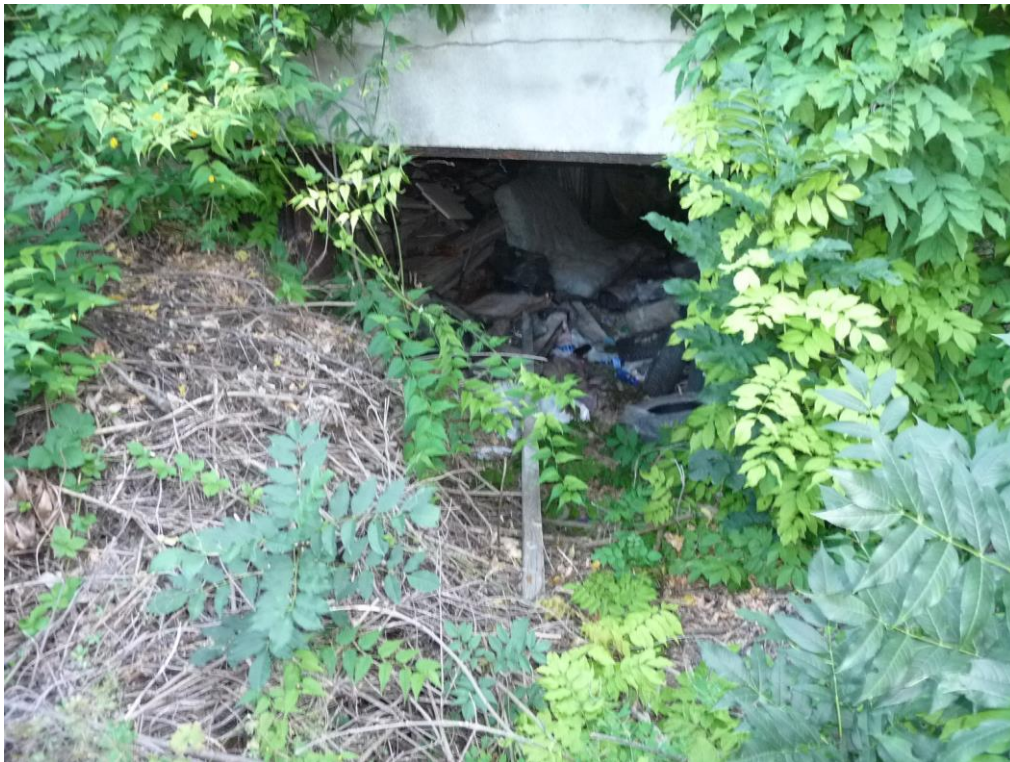
Foto 23 – Locale “autorimessa” ingombro ed inagibile
