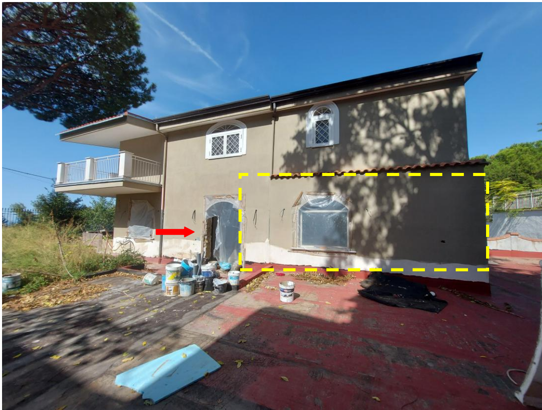
prospetto nord-est - accesso al cespite ed indicazione volumetria e affaccio cespite pignorato
