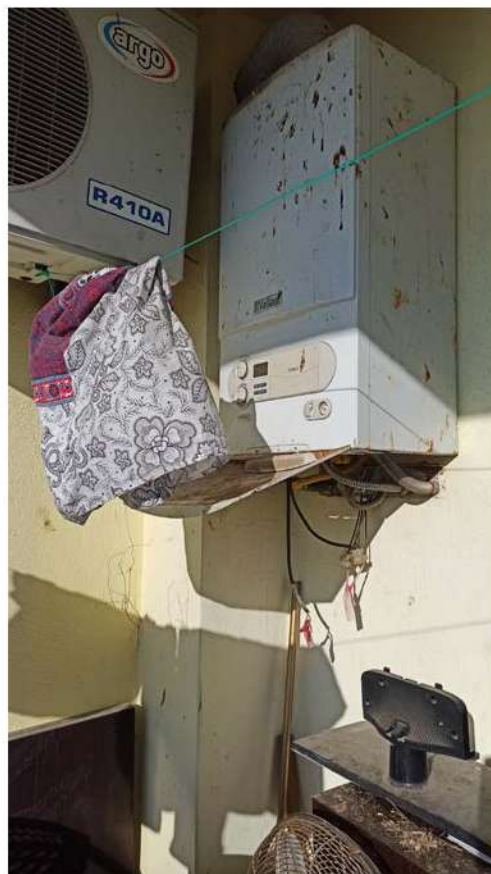
FOTO 18 – CALDAIA SU BALCONE
