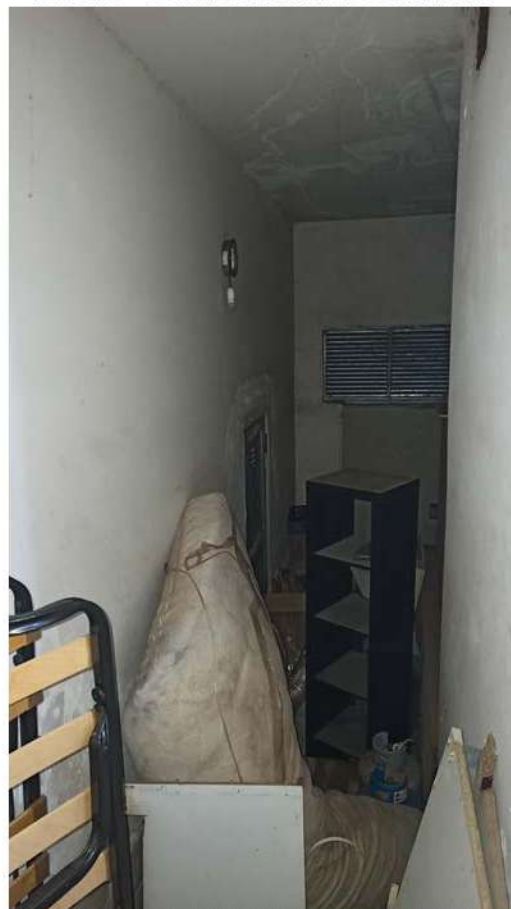
FOTO 28 – ACCESSO AI LOCALI SCANTINATI OSTRUITO DA MOBILI
