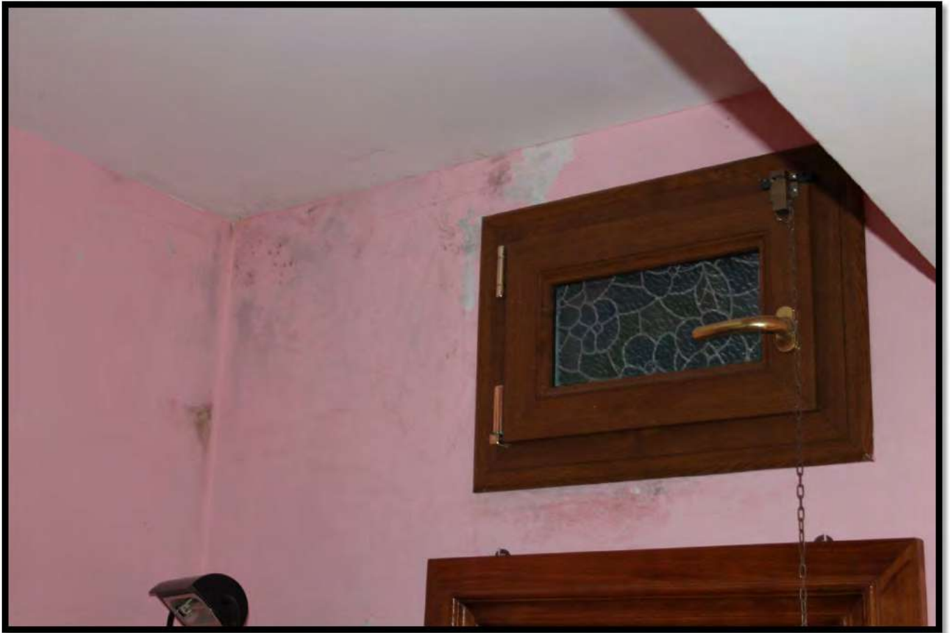
174. Angolo dello spogliatoio con escrescenze di muffa
