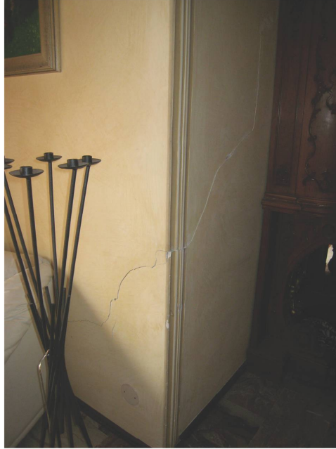
fessurazione passante muro tra salone e cucina
