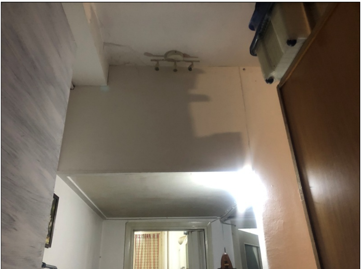
INGRESSO E DETTAGLIO SOPPALCO (ABUSO)
