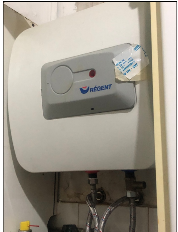
BOILER ACQUA CALDA
