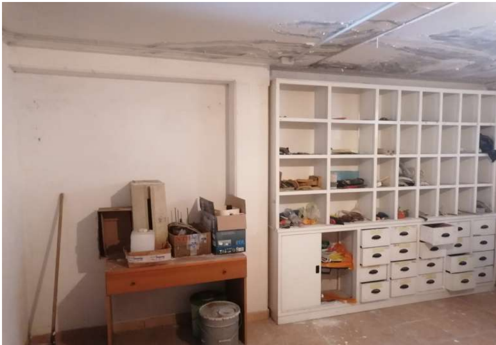
interno garage ( vista infiltrazioni dal solaio , ora bloccate )
