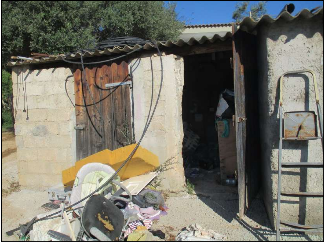
Particolari del locale abusivo.
