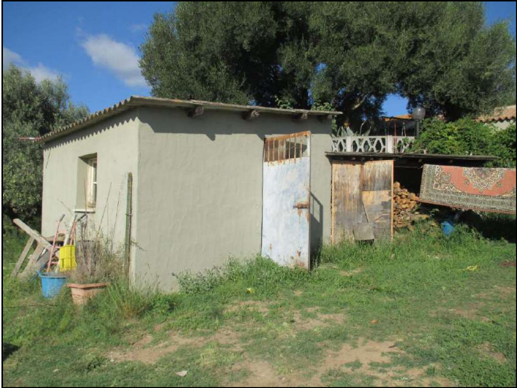
Vista di uno dei locali abusivi presenti all'interno della proprietà.
