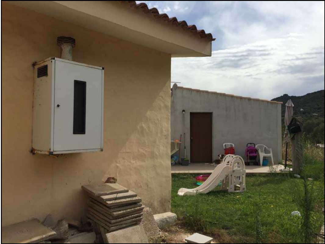
Vista di scorcio dell'immobile abusivo.
