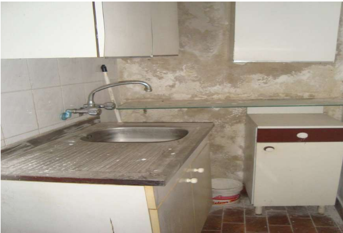
foto n°8 “Locale cucina ricavato fuori sagoma ed oggetto di ripristino ”
