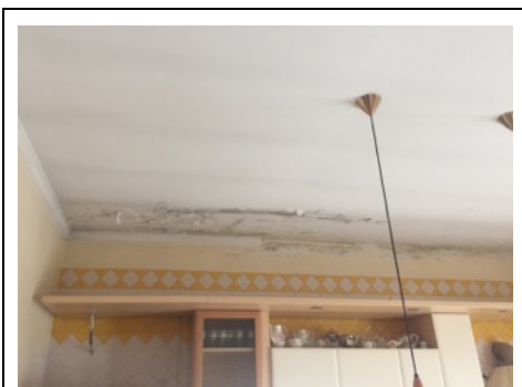
Immagine n.20 – danneggiamento cucina
