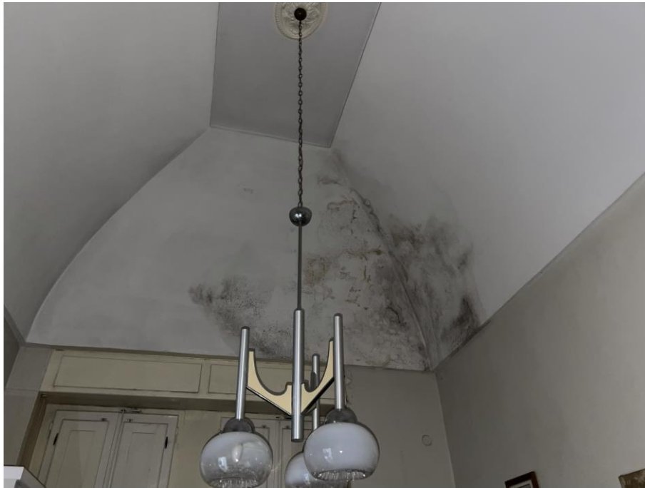
FOTO 14: UMIDITA' DI RISALITA
