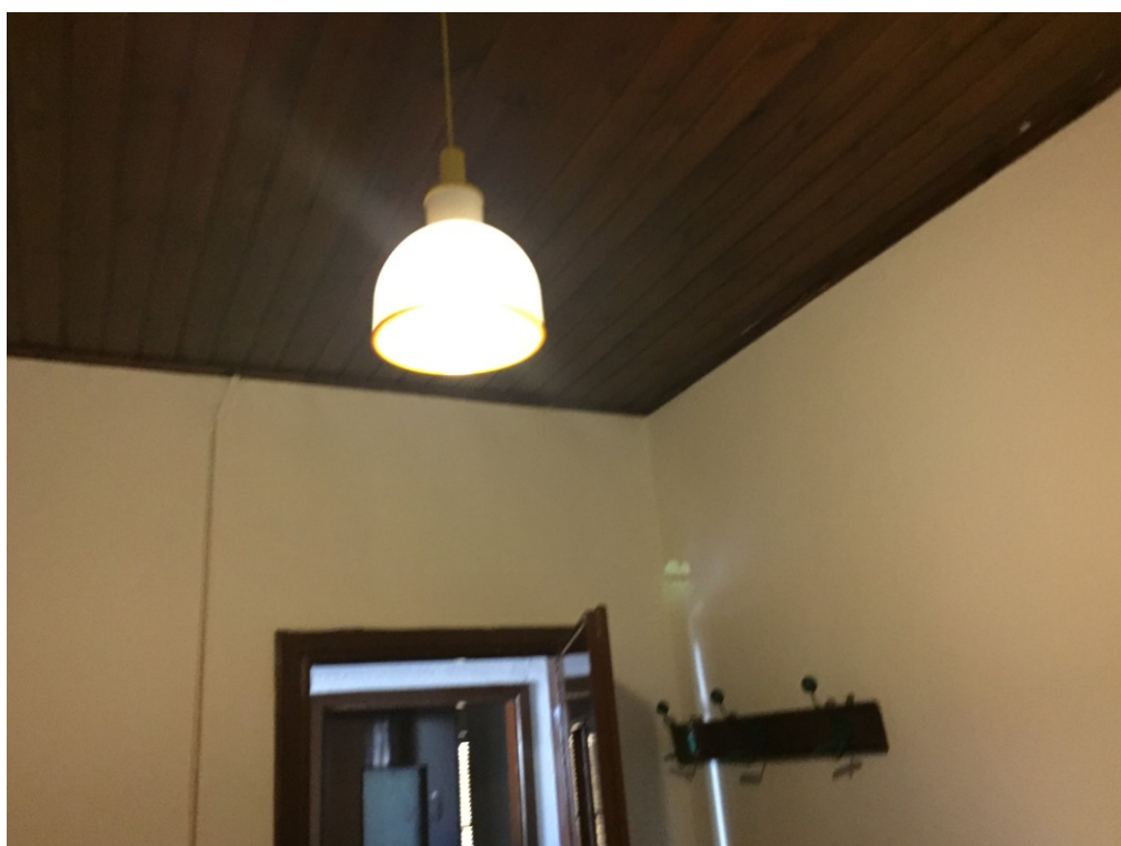
Foto n. 29: particolare soffitto abitazione CEA
