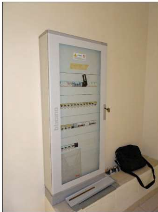
Foto 44: Vista particolare quadro elettrico
