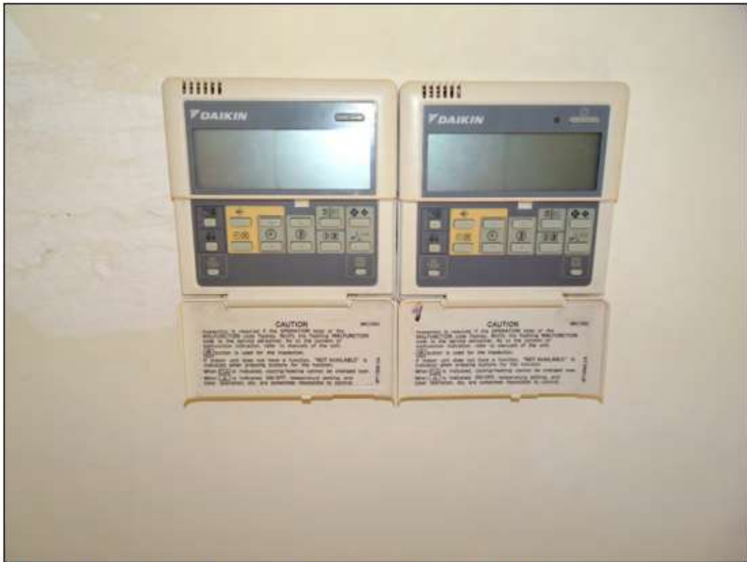
Foto 43: Vista particolare comandi del condizionatore a soffitto
