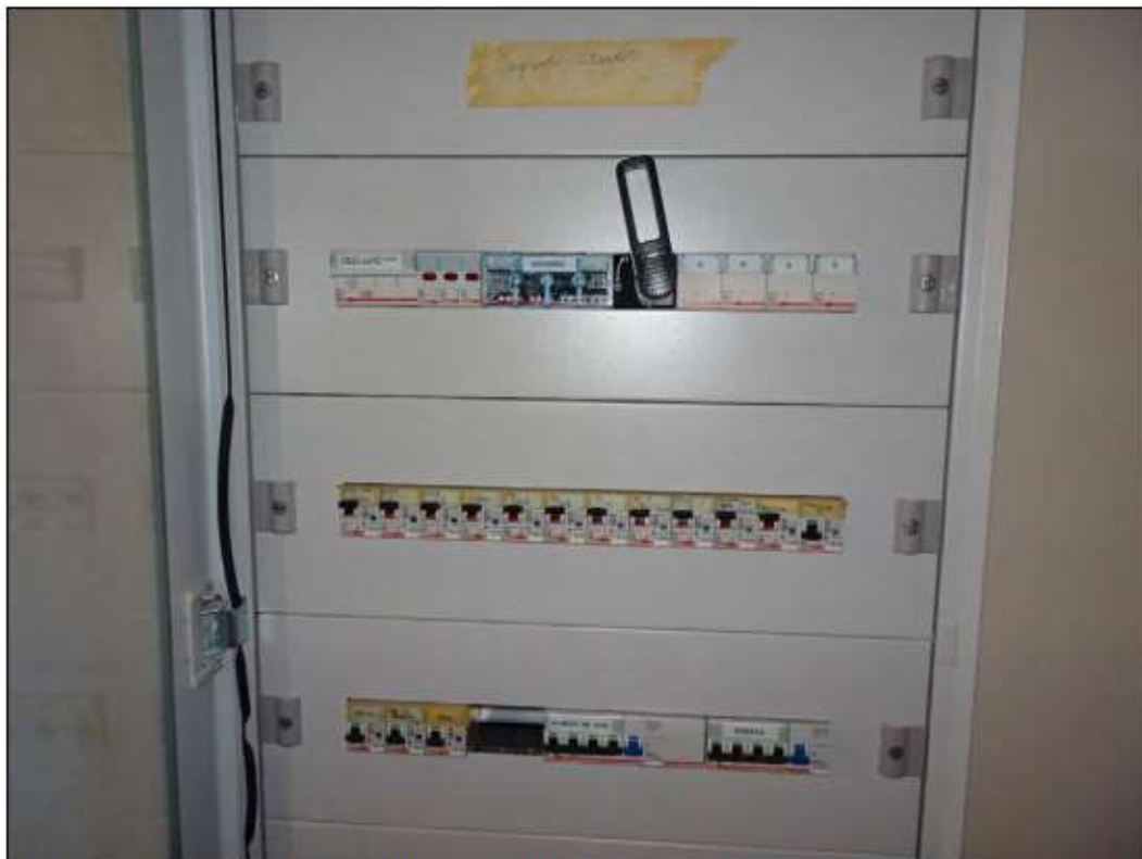
Foto 45: Vista particolare quadro elettrico
