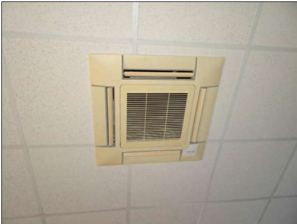
Foto 42: Vista particolare condizionatore a soffitto
