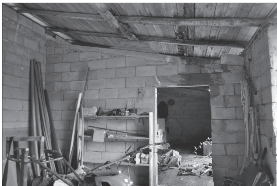
Figg.42-43-44. Interni del vano deposito e dettaglio della copertura con rilevante cedimento
